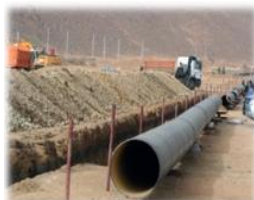
A Photo d'une conduite d'eau
