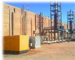
B: Photo des ouvrages d'une station de pompage
