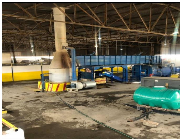
Figure III.4 : installation d'incinération de l'EPWG -CET
