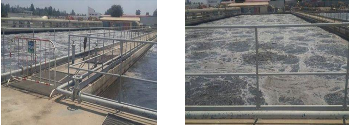
Figure 28 : Le bassin d'aération
