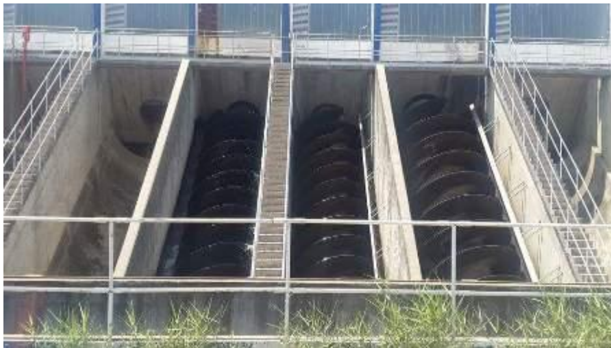
Figure 25 : Poste de relèvement numéro 2 (PR2)
