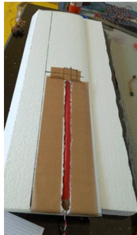
Passage du câblage
