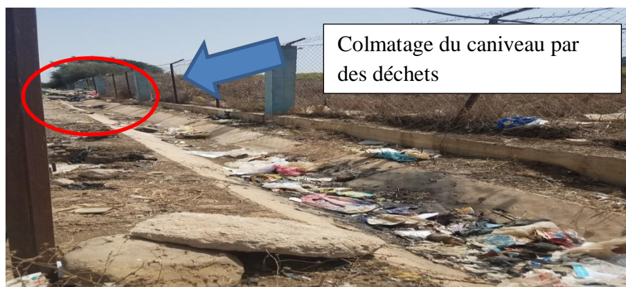
Figure 2.28 : colmatage des déchets sur le caniveau
