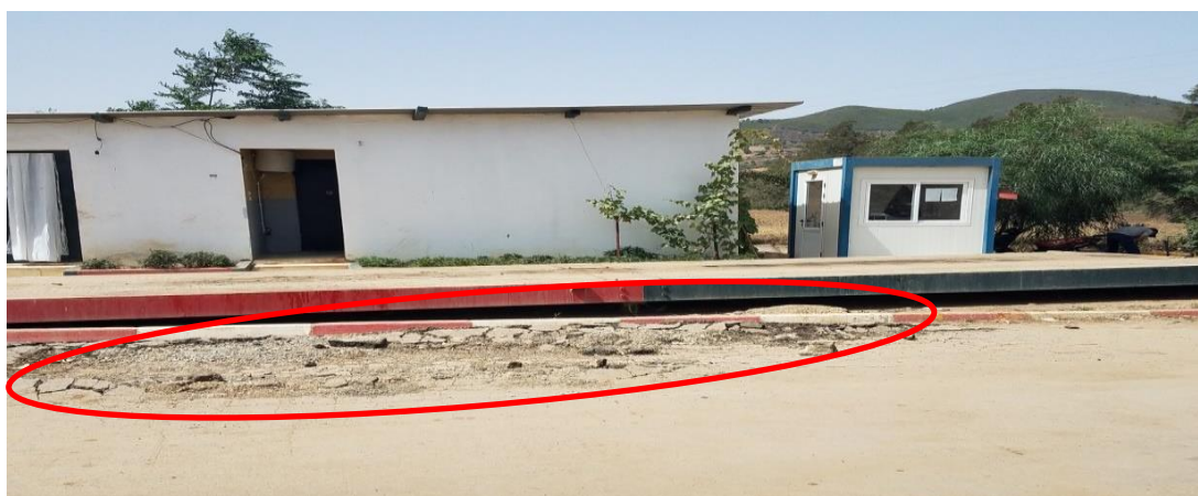
Figure 2.15 : Route avoisinant le pont bascule endommagé
