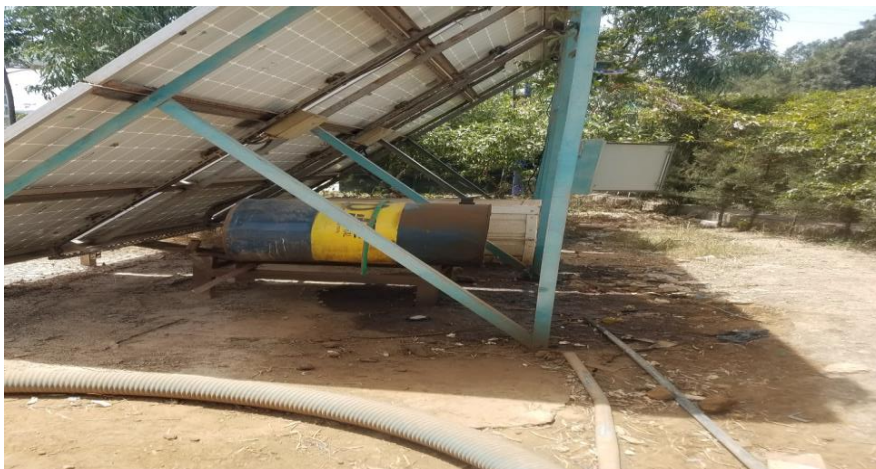
Figure 2.16 : stockage de carburant sous le panneau solaire
