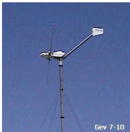
Figure G.7 Aérogénérateur VERGNET GEV 7/10
