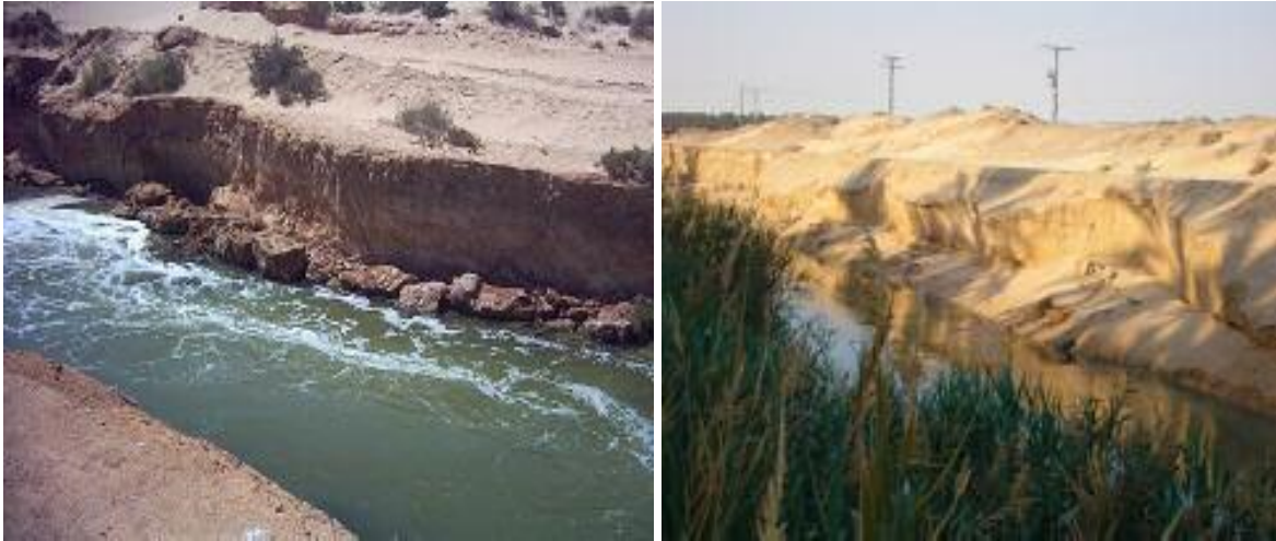
Photos 2.8 : Dégradation des berges par l'érosion et des affouillements des talus sur plusieurs tronçons du canal de l'Oued Righ en 2008.
