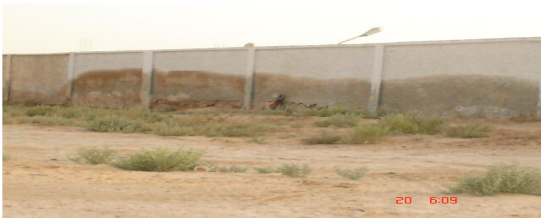
Photo 2.16 : Ecoule primaire envahi par l'eau de la remontée dans la zone de Tinedla en 2008.
