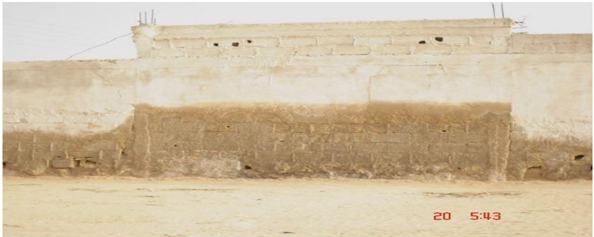
Photo 2.15 : Détérioration et effondrement des habitations dans la zone de Sidi Amrane en 2008.
