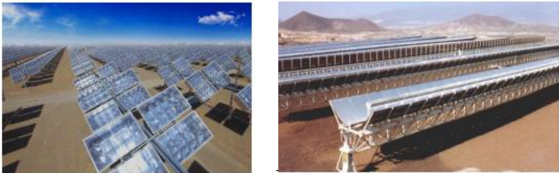
Figure (II- 2) : Deux technologies de modules CPV en centrale ; à gauche les modules HCPV Suncore sur la centrale de Golmud en Chine (60MW) et à droite le système LCPV EUCLIDES sur La central prototype de Tenerife en Espagne (500kW). [15]
