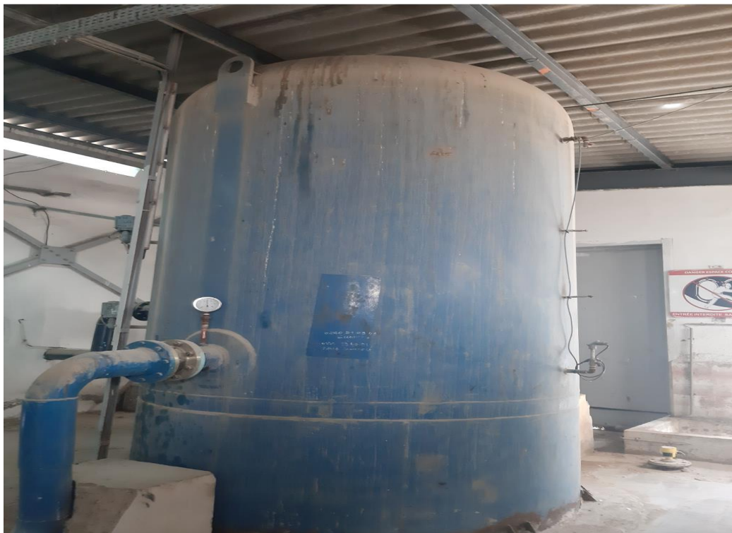
Figure 1.20 : réservoir d'eau de la station de pompage
