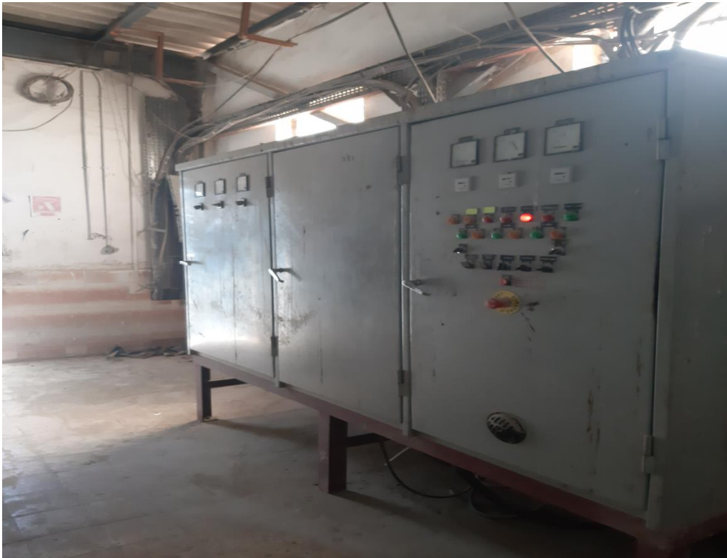
Figure 1.21 : armoire de station de pompage
