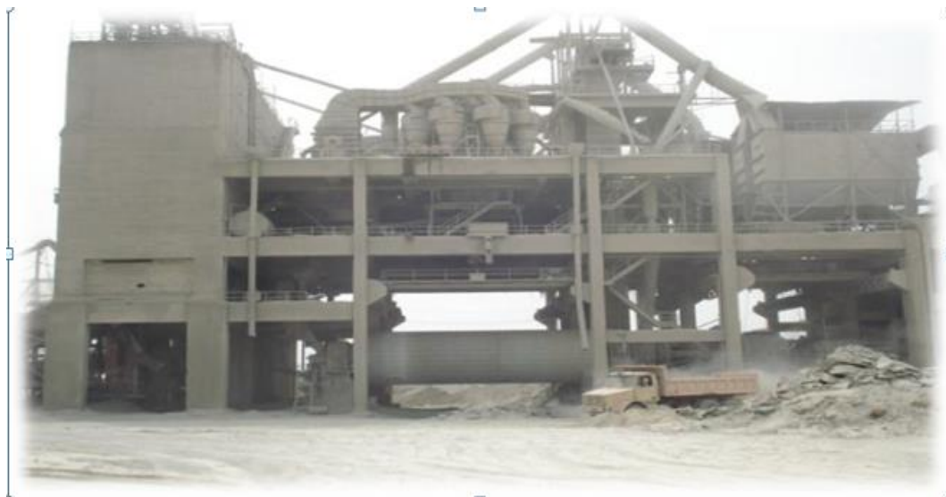
Figure 1.8 : broyeur à boulets
