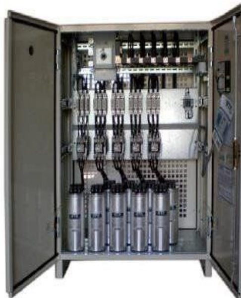
Figure 1. 14 : Batterie de condensateur
