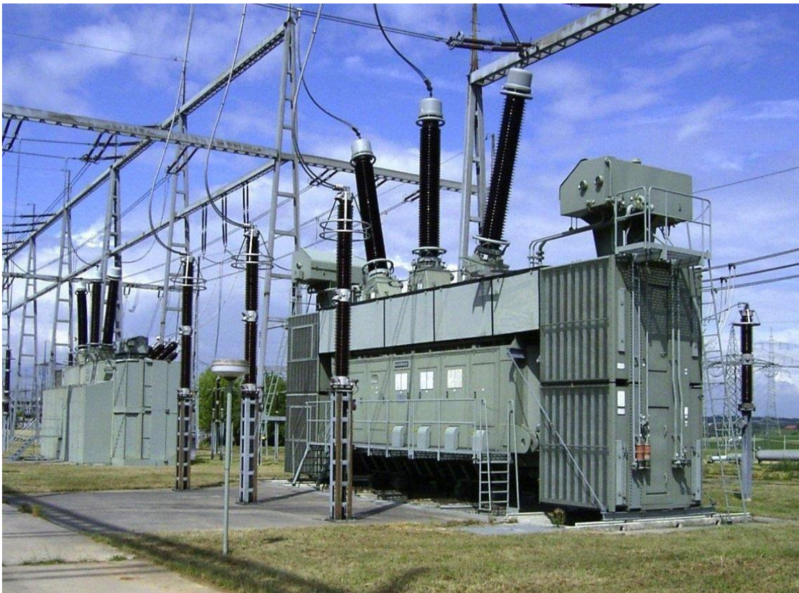
Figure 1. 7: Un transformateur de puissance dans un poste électrique
