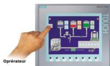
Figure 2.42 IHM marque siemens
