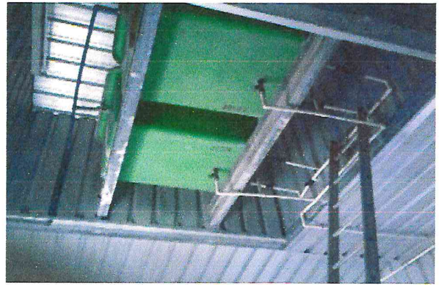
Figure n° 16 : Les bacs d'eau
