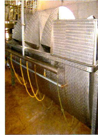
Fg3 : Refroidisseur à eau
