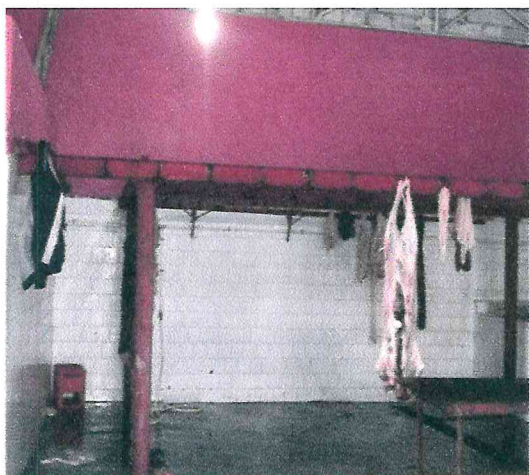
Figure N° 9 : Etats des murs.
