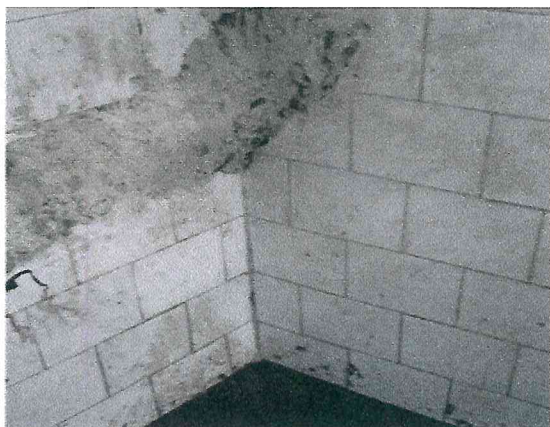
Figure N°15 : Etats des murs après nettoyage.
