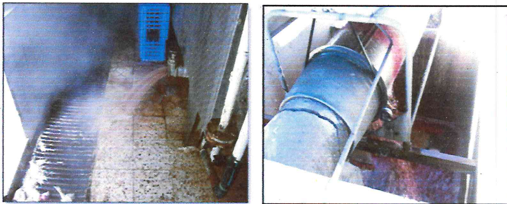
Figure n° 06: Système d'évacuation des eaux usées. (Photo personnelle)
