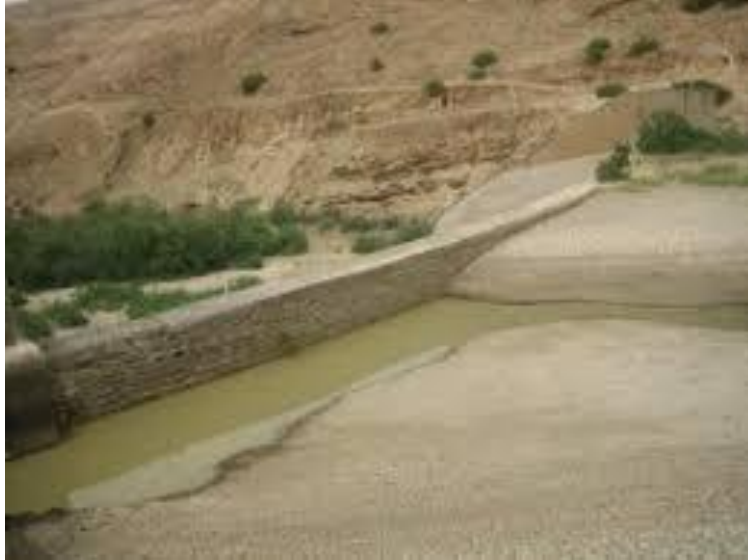
Figure 1-6 : Comblement total d'un petit barrage (HAMMOUDI,2004)
