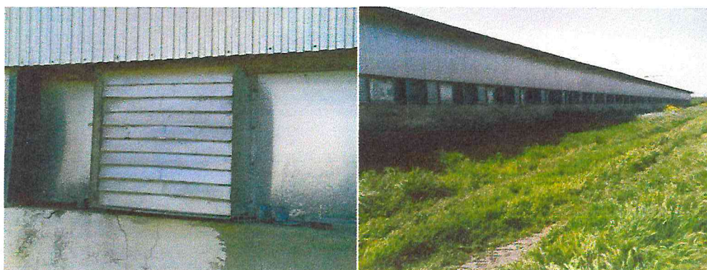
Photo 7 : les extracteurs de ventilation (Photo personnelle).
