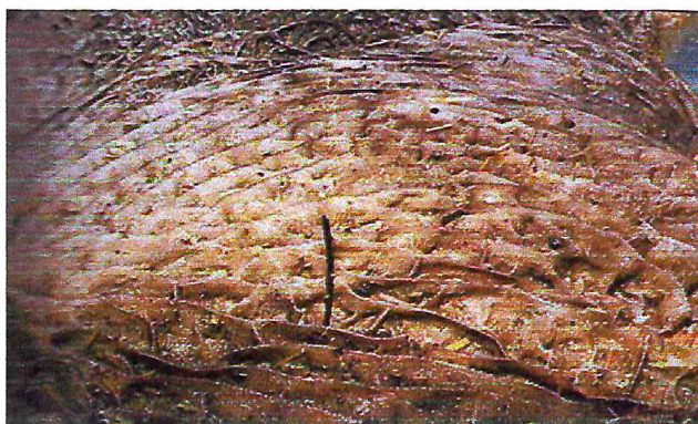
Figure n°11 : Elément métallique piqué dans le réseau. (VALLET.A, 2000)
