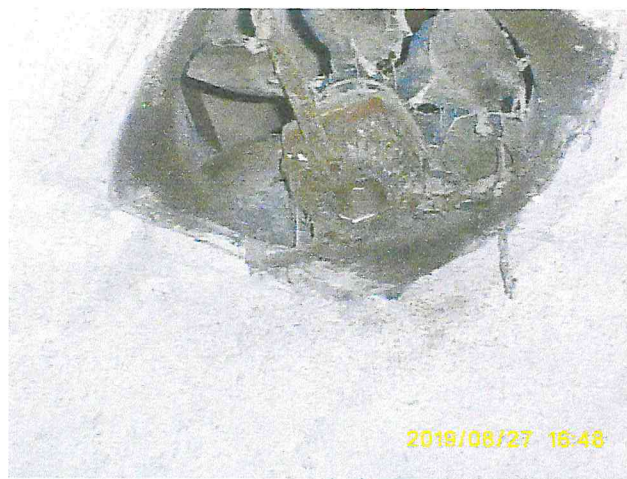
Photo n°01 : Extracteur placé en haut du bâtiment
