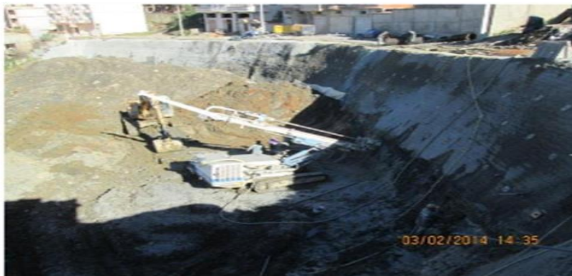
Figure 1.20 : un glissement de terrain s'est produit sur une partie de la route et les travaux pratiquement achevés.
