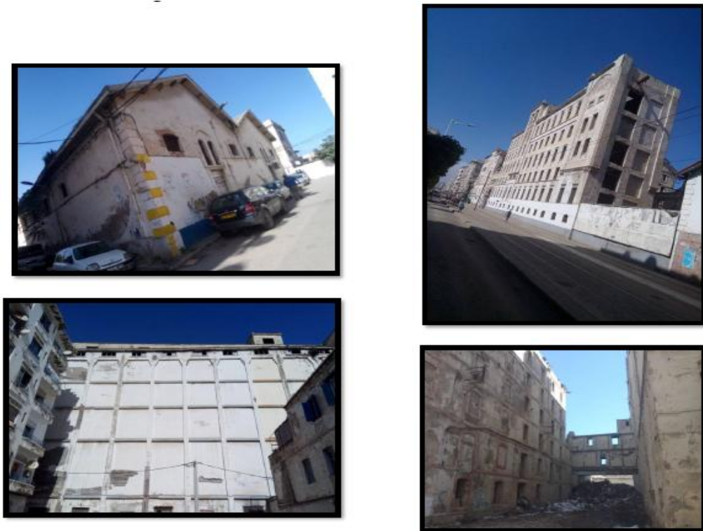
. Figure III.37 : Etat de fait des différents blocs de la minoterie Narbonne.
