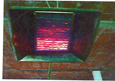
Photo 6: Chauffage au gaz
