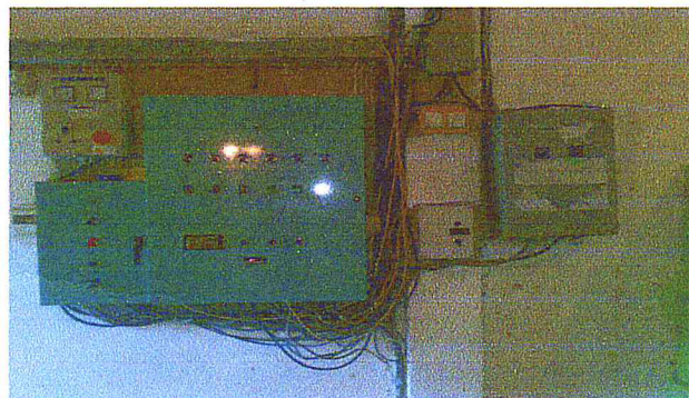
Figure 20 : le système de commande programmable (photo personnel 2010)
