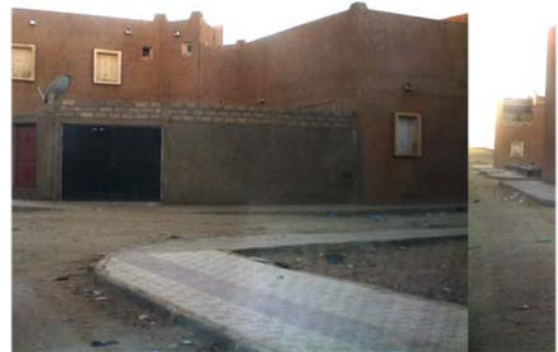
FIGURE 41 : EXTENSION NON REGLEMENTAIRE ET AGRANDISSEMENT DE LA COUR, AL JAZIRA
