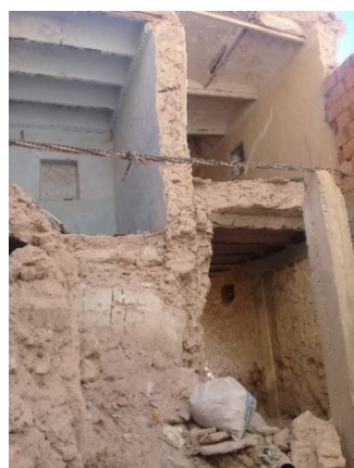
FIGURE: ETAT DE DEGRADATION
