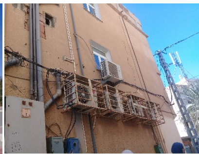
FIGURE : UTILISATION DES CLIMATISATIONS
