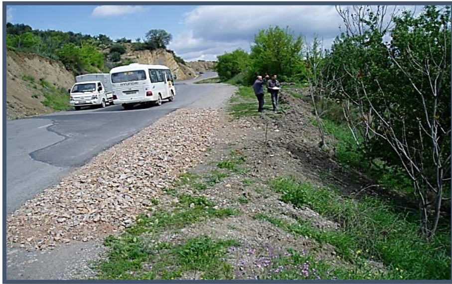
Figure IV.1 Affaissement et glissement de terrain de la route
