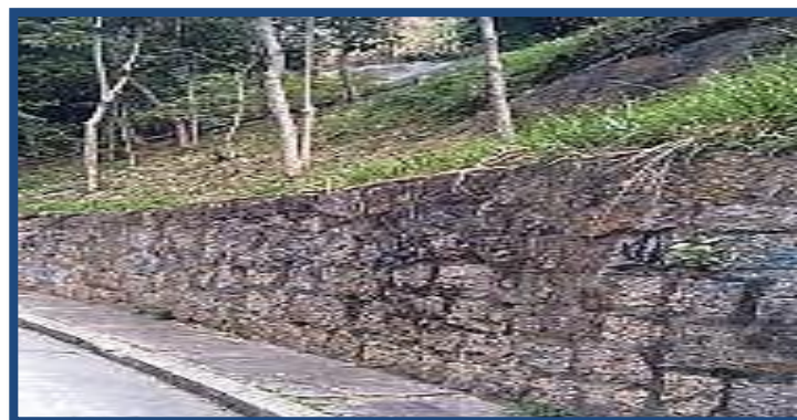
Figure I.13 Désagrégation des parois d'un mur de soutènement
