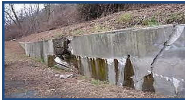
Figure I.12 Cas pathologique d'un mur de soutènement.
