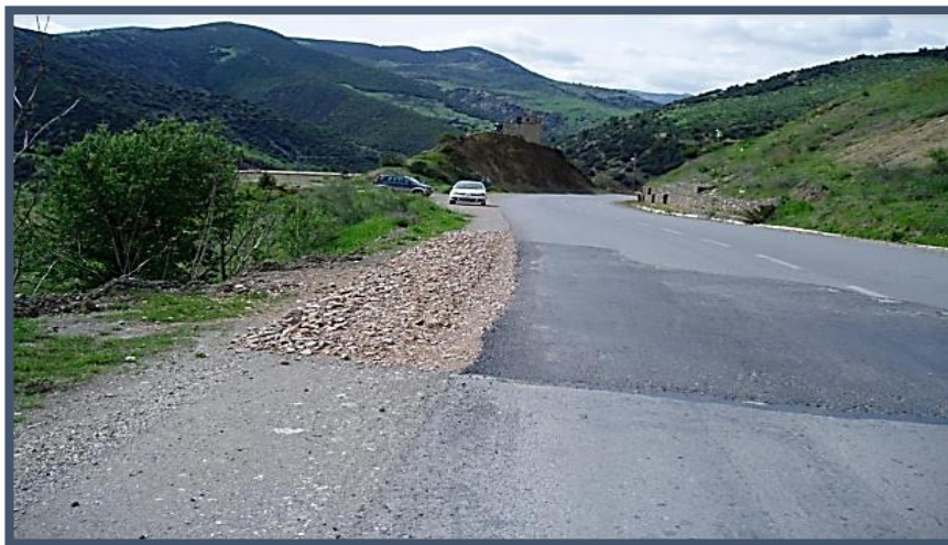
Figure IV.3 : Etat de dégradation de la chaussée de la route.
