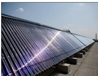
Figure 66 : Panneaux thermiques solaires
