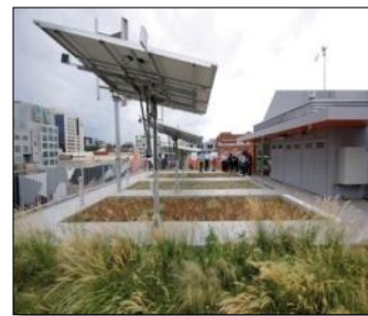
Figure 65 : panneaux photovoltaïques sur terrasse
