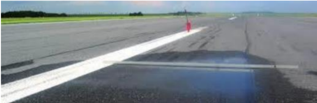
Figure I.17 : Route avec désordre du profil.(11)
