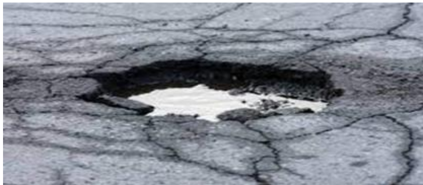
Figure I.26: Des endroits de nids de poule au niveau de la surface d'une chaussée
