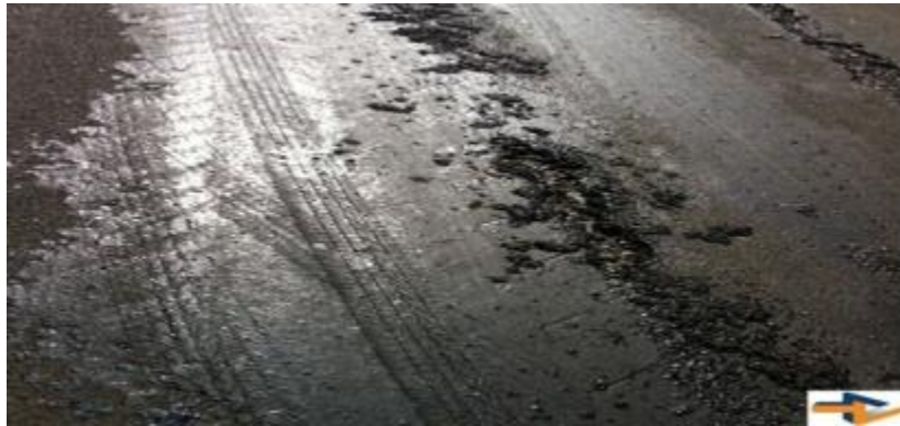
Figure I.27: Images d'une route avec traces de ressuage.
