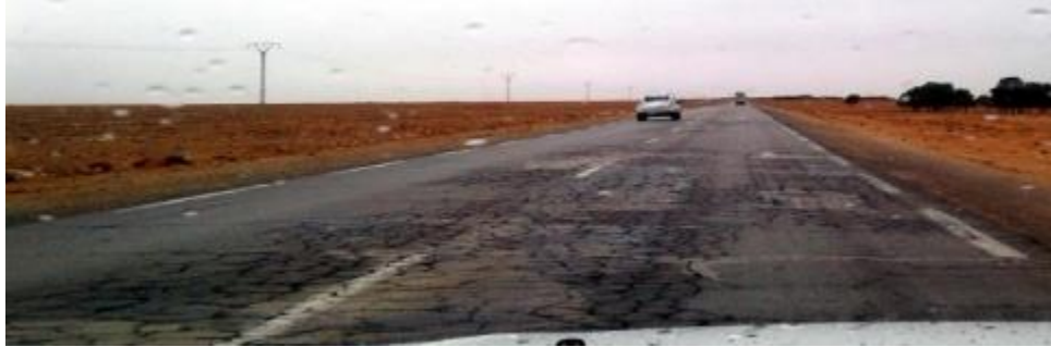
Figure 1.21 : Fissures de carrelage au niveau de la RN 6 reliant le nord-ouest au sud-ouest)
