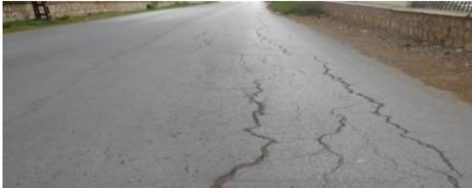
Figure I.20 : route de montagne avec fissure de gel.
