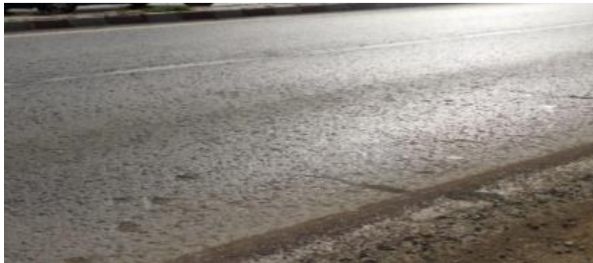
Figure I.24 : Route avec le phénomène du dés enrobage.
