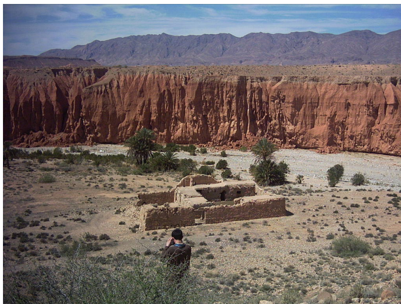
Fig. 2.2. Sapement des berges dans l'oued Abiod à l'amont du barrage (Remini, 2004)
