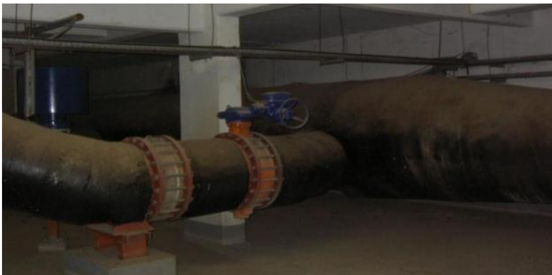
Figure V-10: Equipement de la centrale de production d'air
