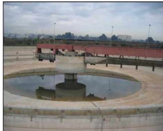
Figure IV.29: Vue générale du clarificateur
