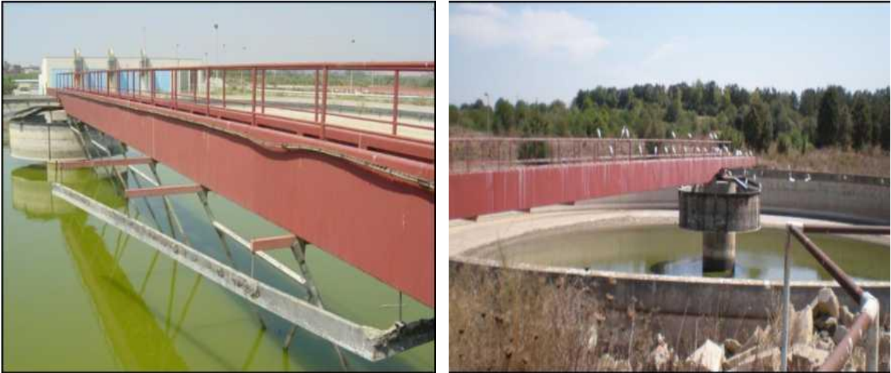
Figure IV.25: Etat de l'équipement décanteurs primaires
