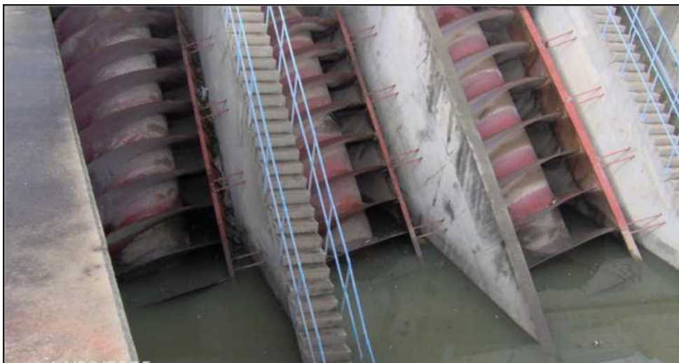
Figure IV.2: Poste de relevage N°1(PR1)
