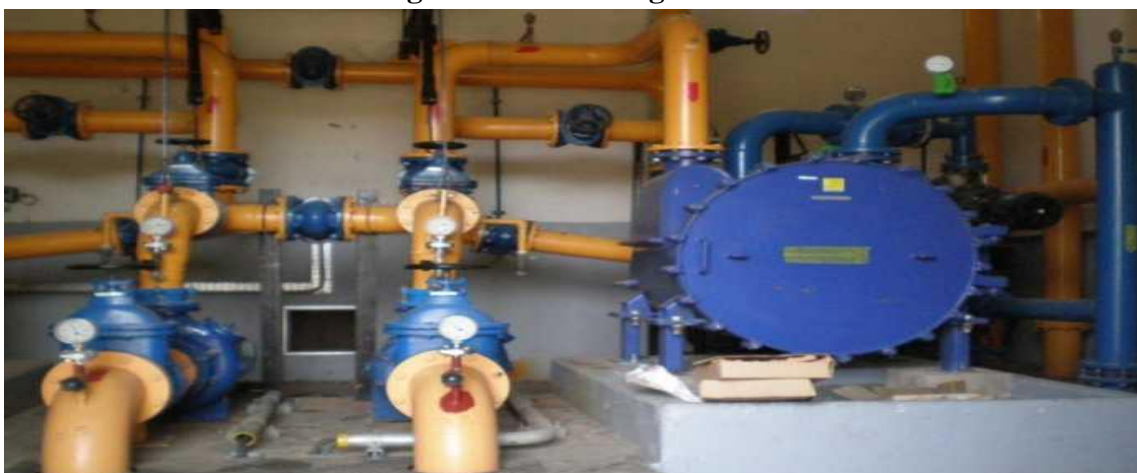
Figure V.18 : Les nouveaux échangeurs thermiques
