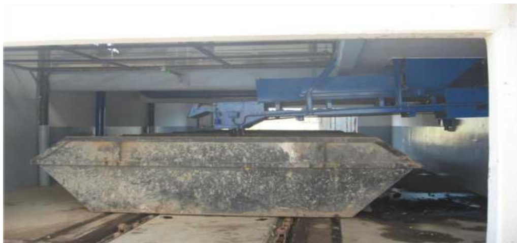
Figure V-5 : Etat du Transporteur à bennes
