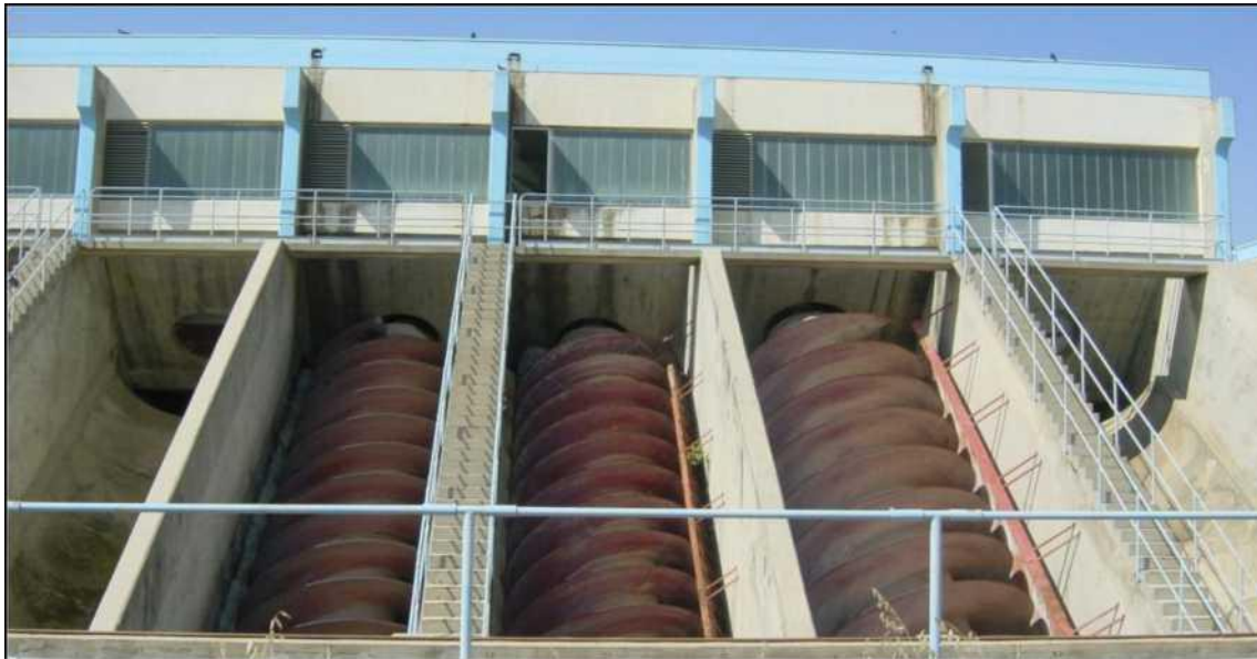
Figure IV. 3 : Poste de relèvement N°2 (PR2)
