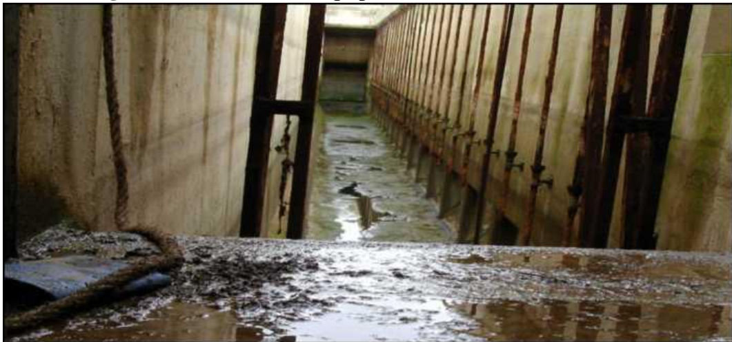
Figure IV.24: Etat du dessableur-déshuileur à l'intérieur
