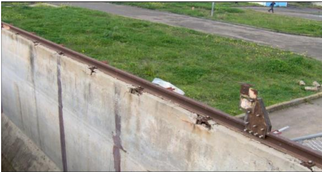
Figure IV.6 : Dégradation du dessableur-déshuileur
