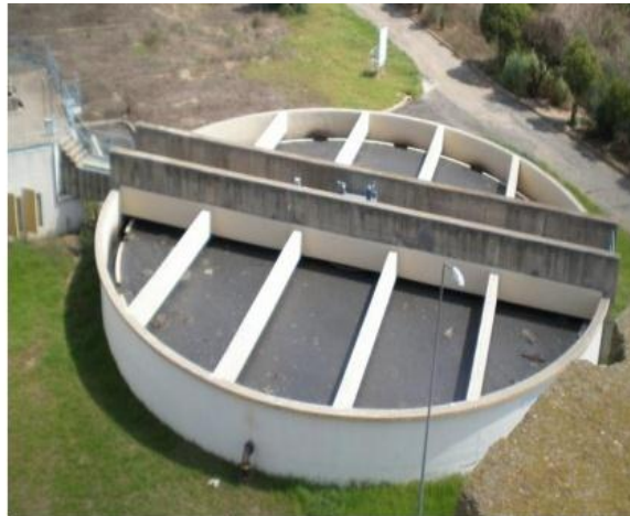
Figure V-15: Epaississeur des boues rempli
