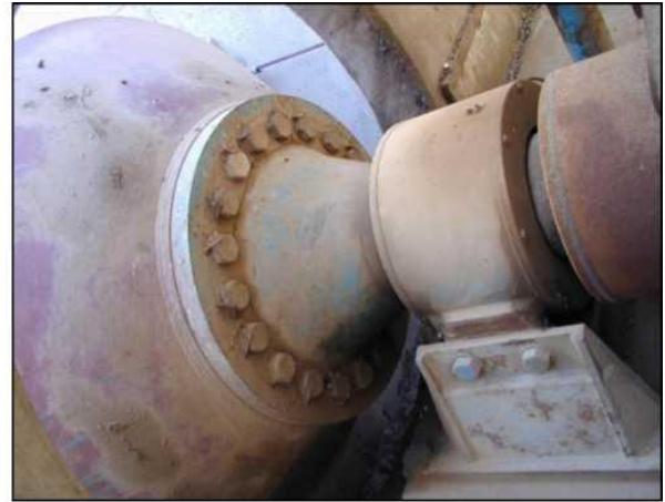
Figure IV.17 : Etat des raccords entre la vis et le Moto-réducteurs
