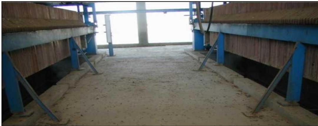
Figure IV.35: Etat des filtres à presse
