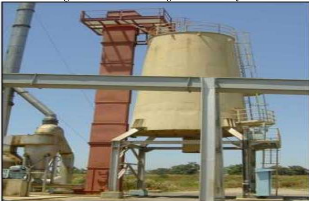
Figure IV.38: Silo de stockage des boues séchées
