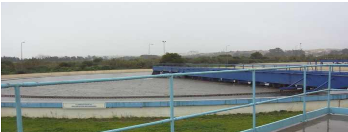
Figure V-13: Le bon fonctionnement du clarificateur après la réhabilitation
