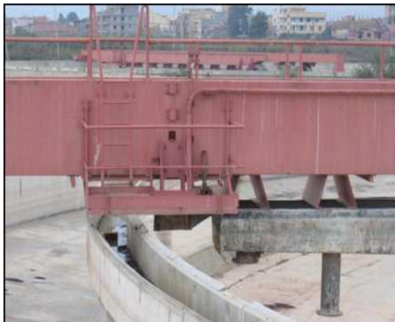
Figure IV.28:Etat de l'équipement du clarificateur
