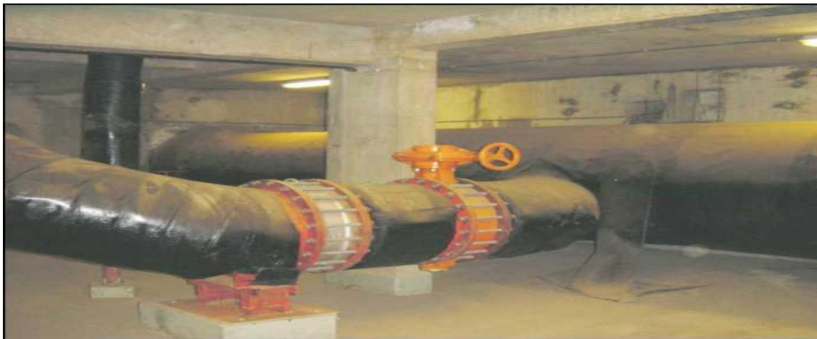
Figure IV.26: Calorifugeage des collecteurs d'air dans la centrale de production d'air
