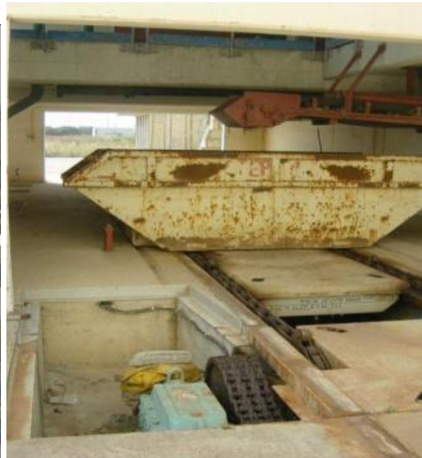
Figure IV.21: Poste de dégrillageBandes (Transporteur à bennes)
