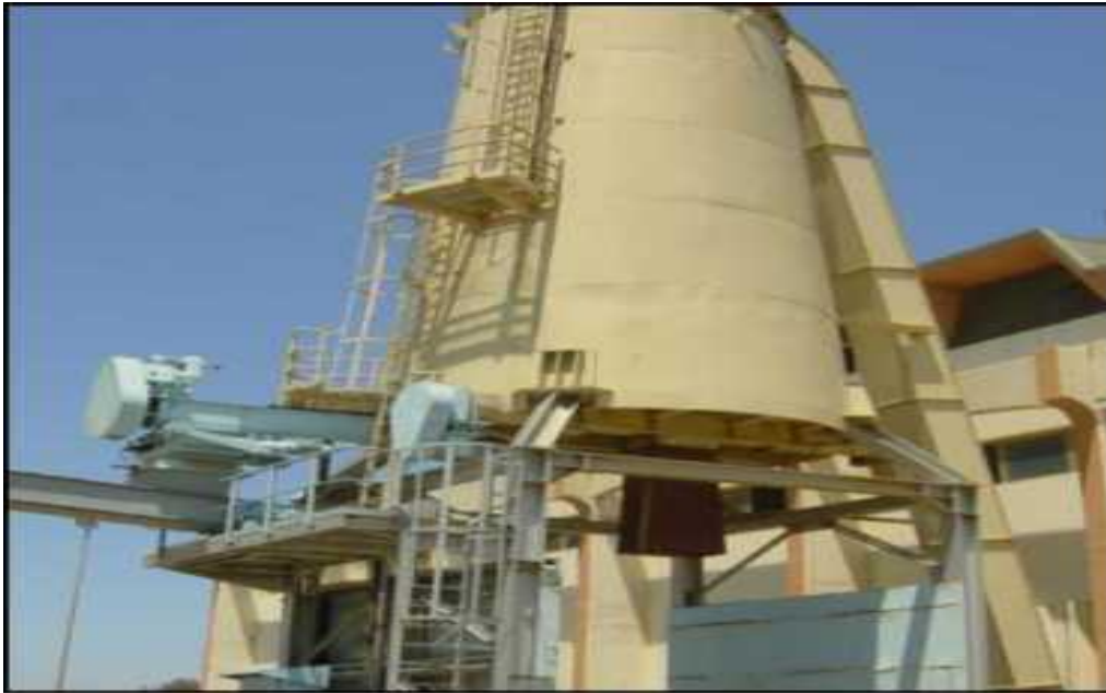
Figure IV.37: Silo de stockage des boues déshydraté
