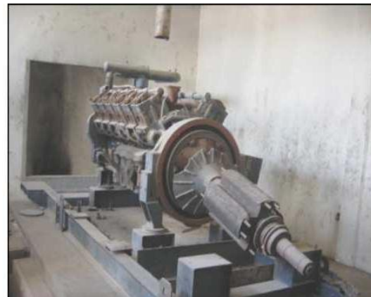
Figure IV.44:Groupe électrogène existant
