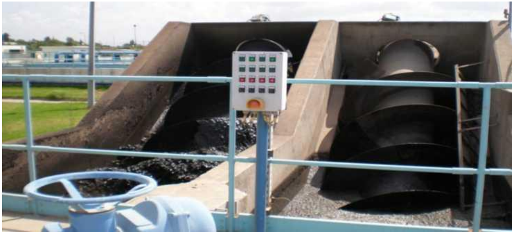
Figure V-11: Poste de recirculation boues en retour
