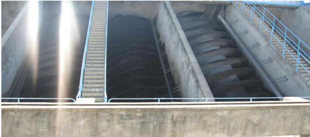
Figure V.1: Etat des vis après la réhabilitation
