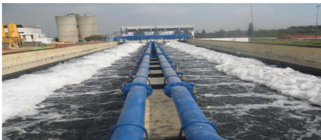
Figure V-7 : Le bon fonctionnement du dessableur-déshuileur
