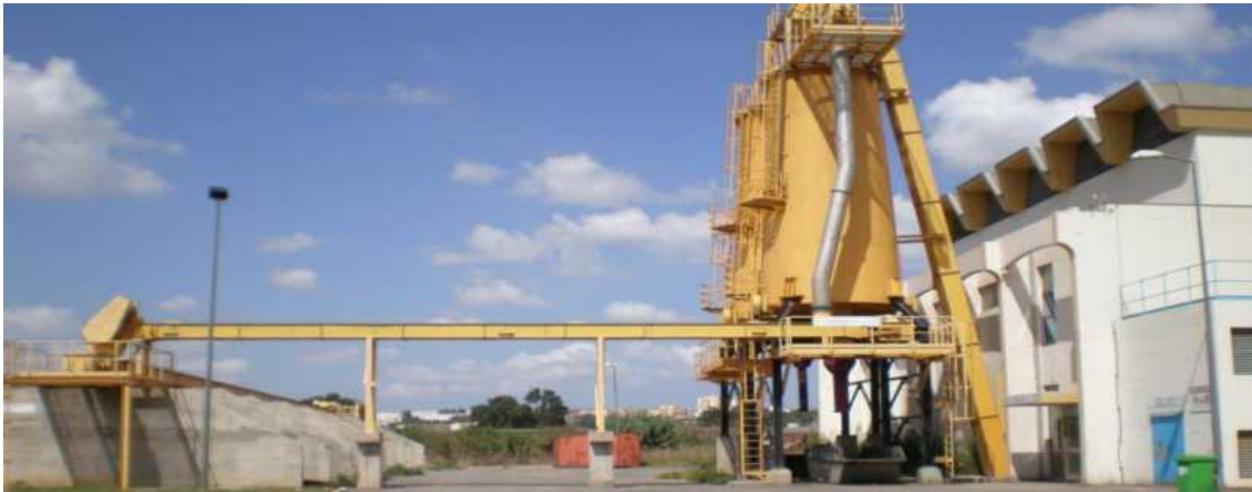
Figure V.25 : Les silos des boues déshydratées
