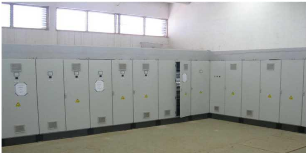
Figure V.30 : La nouvelle chambre électrique
