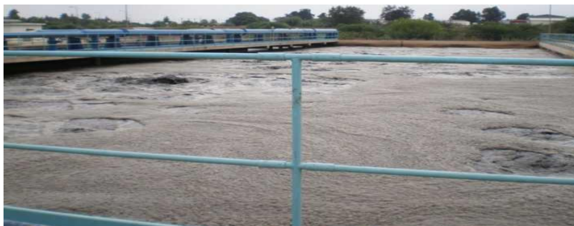
Figure V-9 : Bassin d'aération fonctionnel
