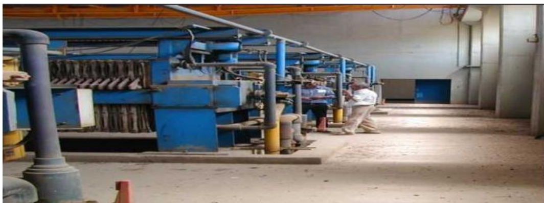
Figure IV.36: Etat des filtres à presse
