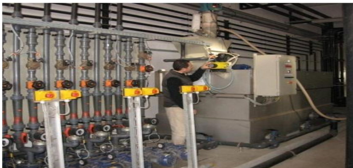
Figure V.24 : Les pompes pour polymère et le local de fabrication de polymère
