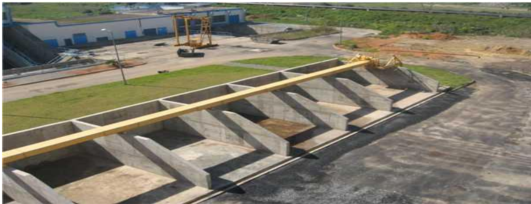
Figure V.26 : Déshydratation - stockage des boues (bac de stockage)
