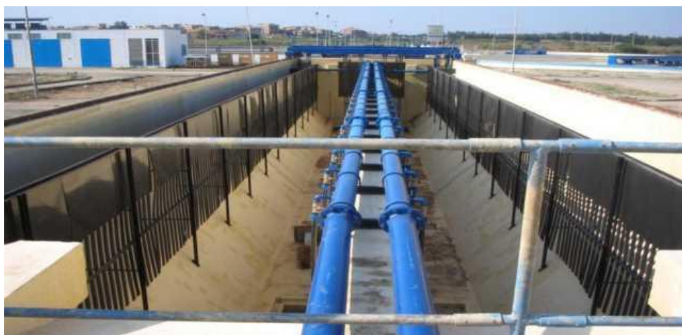
Figure V-6 : Etat du dessableur-déshuileur vide
