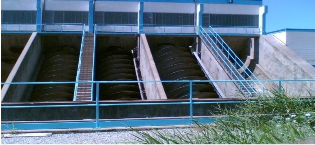
La photo III.1 : Poste de relèvement.
