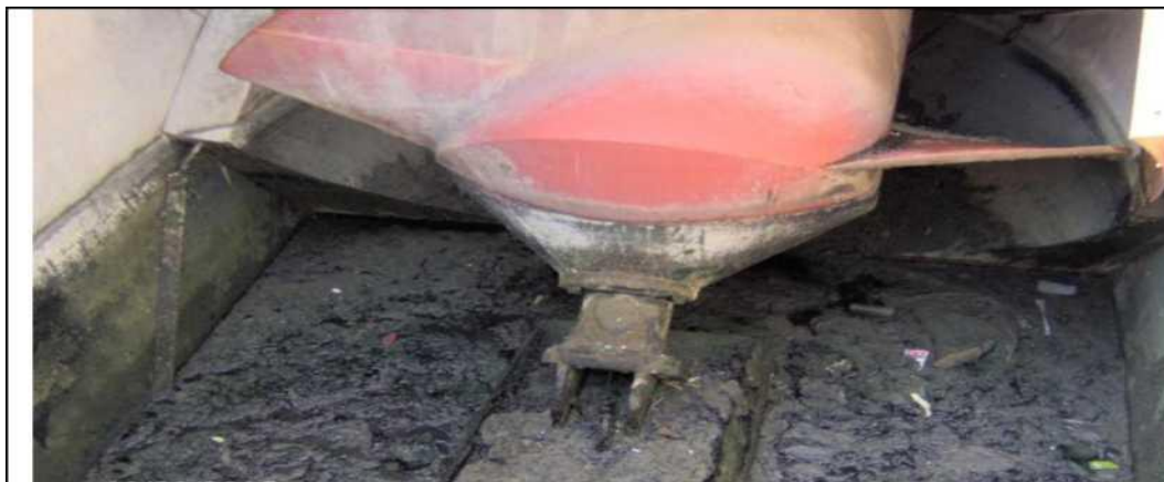
Figure IV.18 : L'état des paliers
