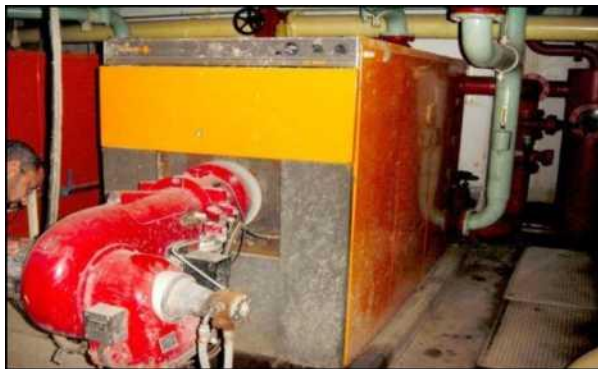
Figure IV.33: Chaudière avec brûleur
