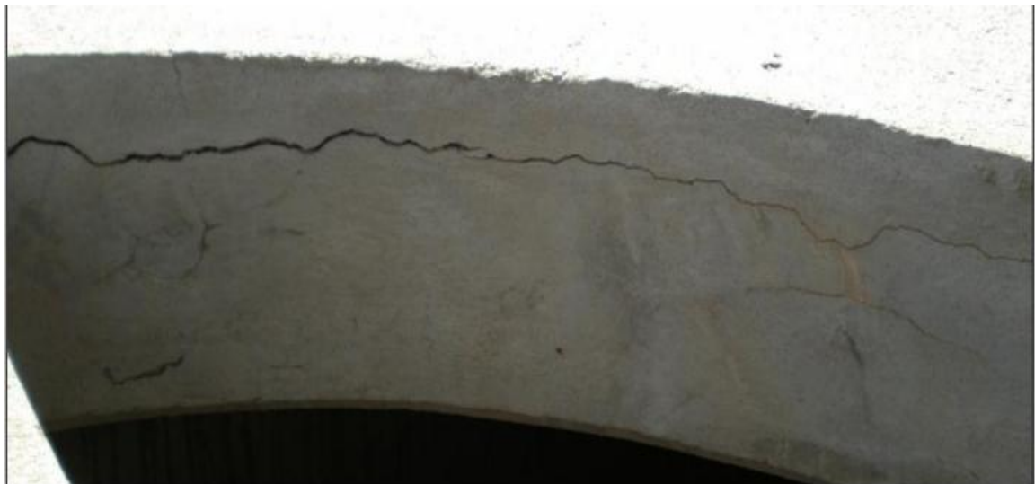
Figure IV.14 : fissures dans le sol
