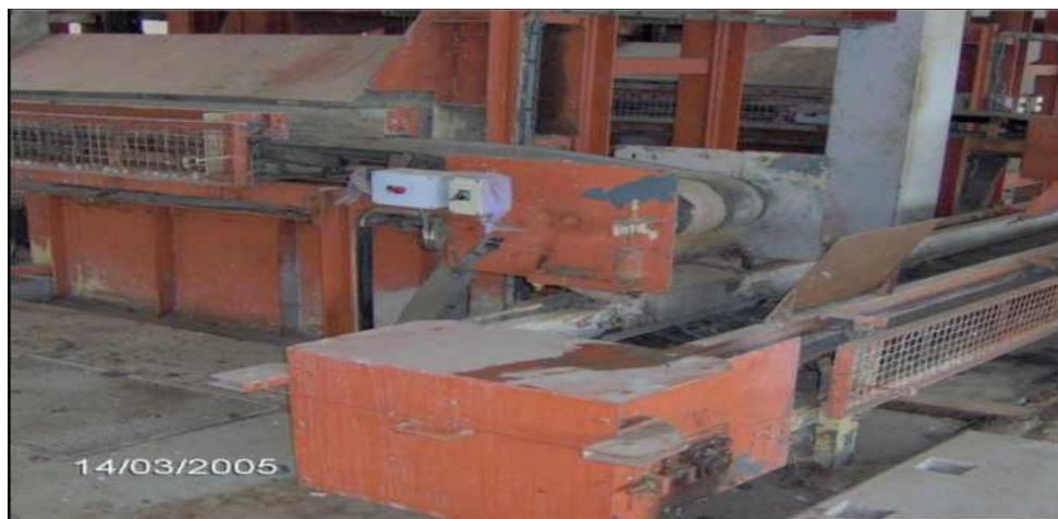
Figure IV.22: Etat de l'équipement du dégrilleur
