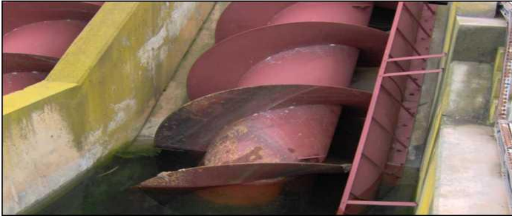
Figure IV.30: État de l'équipement de recirculation des boues
