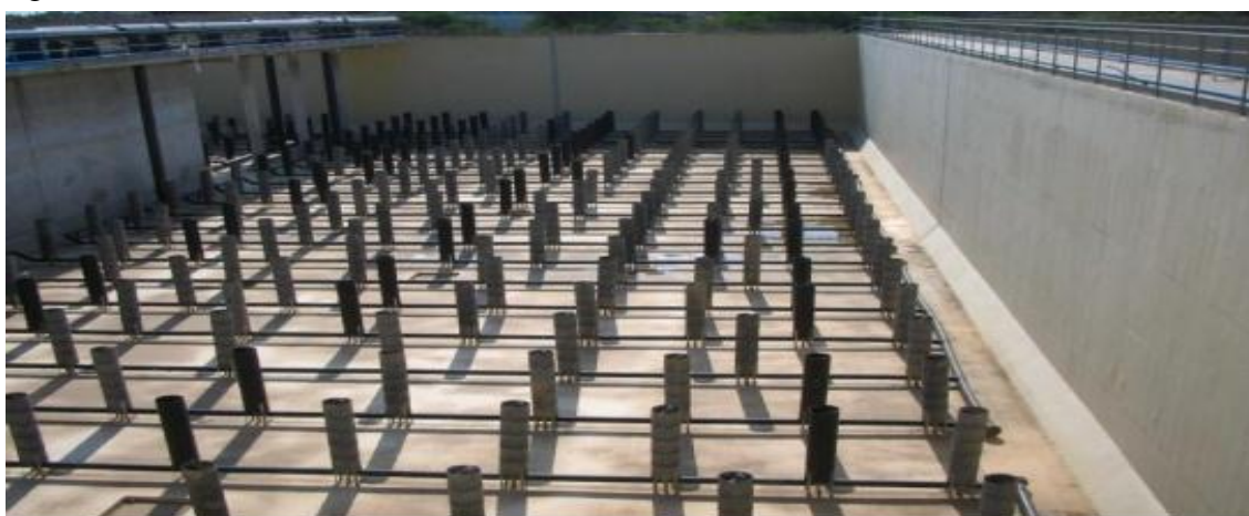
Figure V-8 : Les diffuseurs d'air
