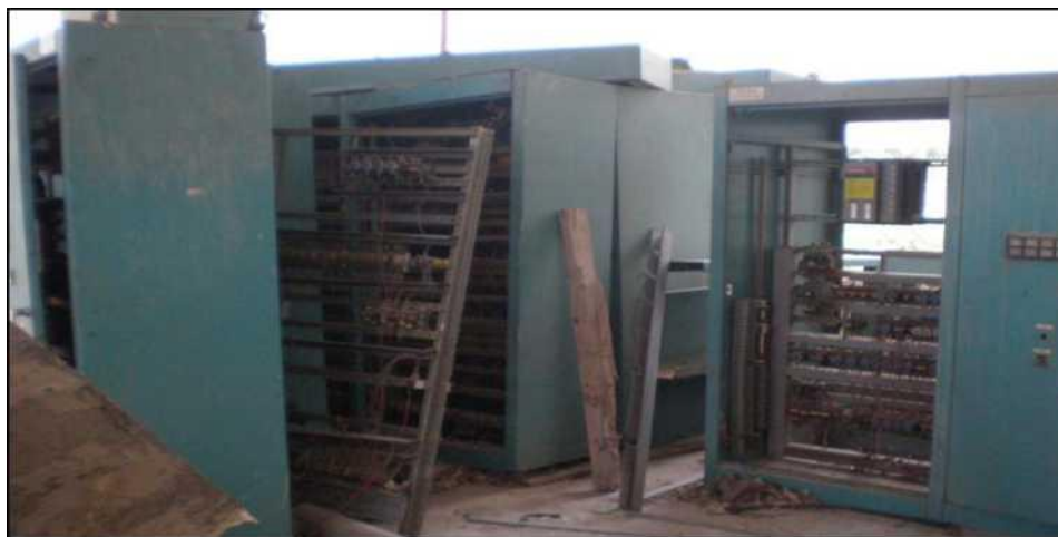
Figure IV.41:Détérioration des cages électriques
