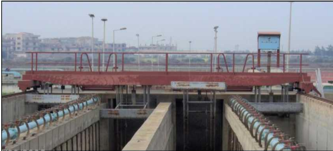
Figure IV.23: usure de l'équipement du Dessableur-déshuileur
