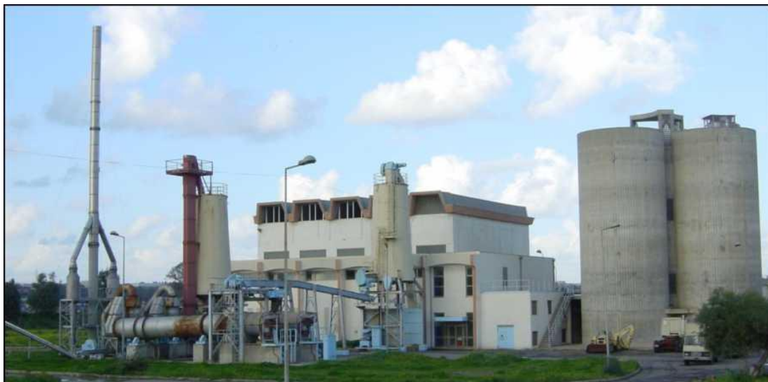
Figure IV.40: Bâtiment de déshydratation mécanique, silos à chaux (à droite), séchage thermique et silos de stockage des boues déshydratées / séchées
