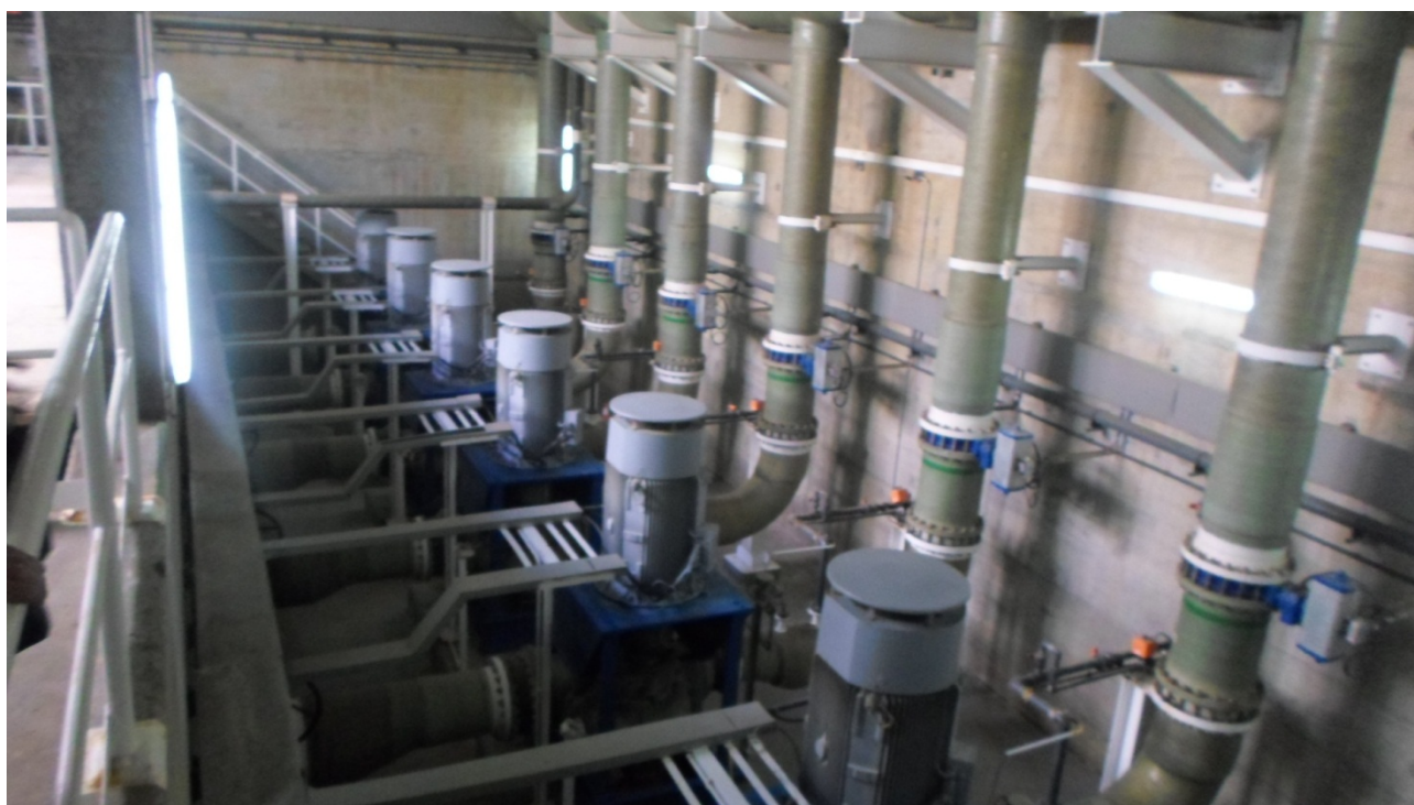
Photo 3-3 : Station de pompage d'eau brute
