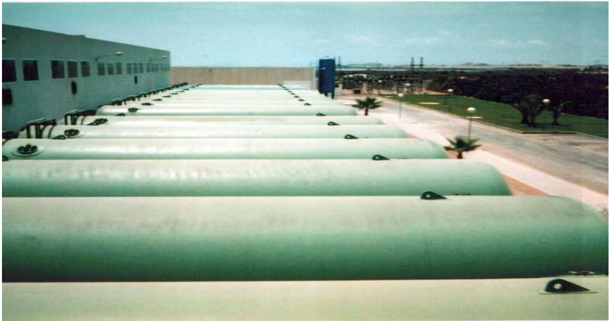
Image 4-1 : Filtre à sable sous pression
