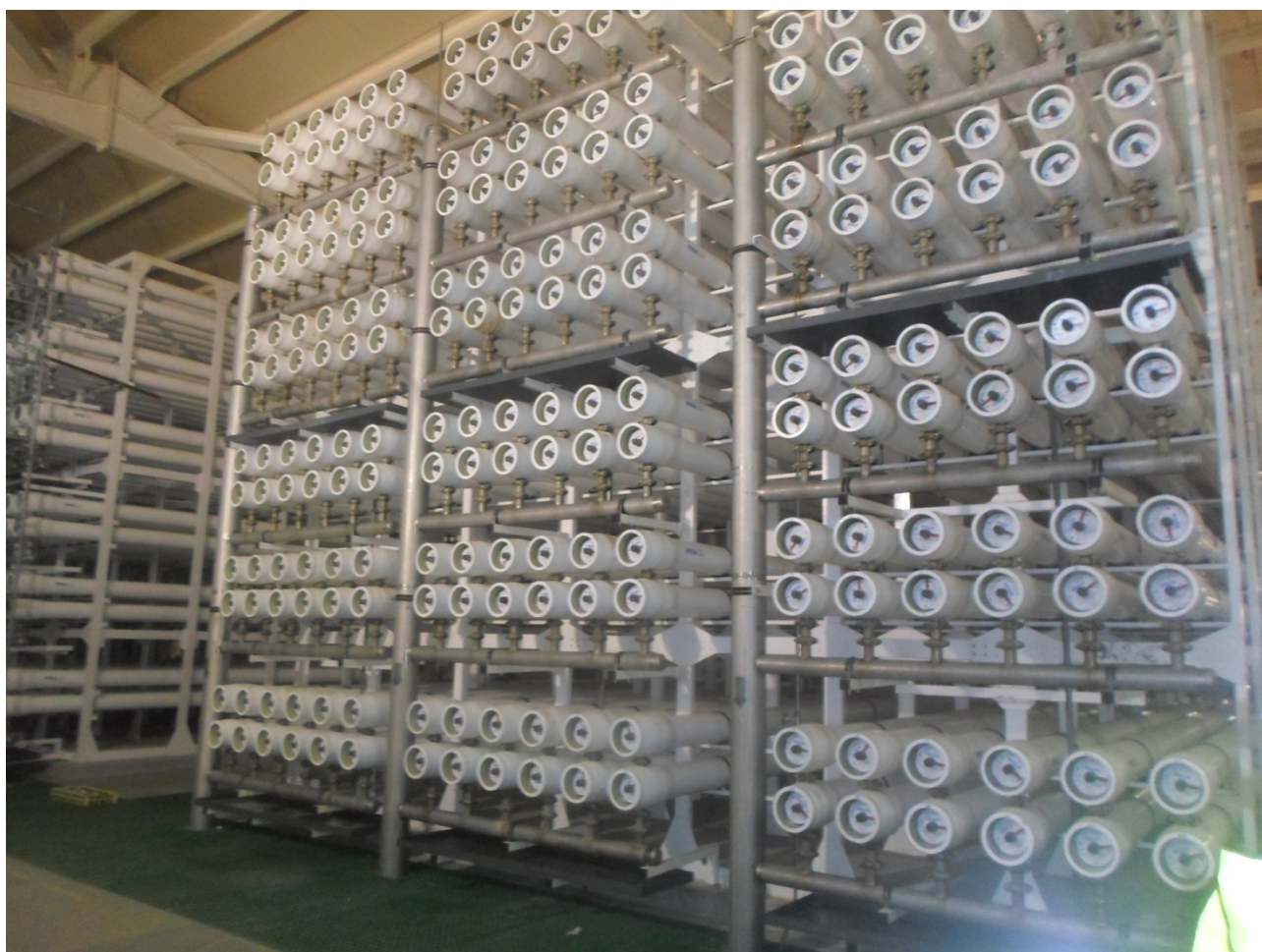
Photo 3-6 : Unité d'osmose inverse
