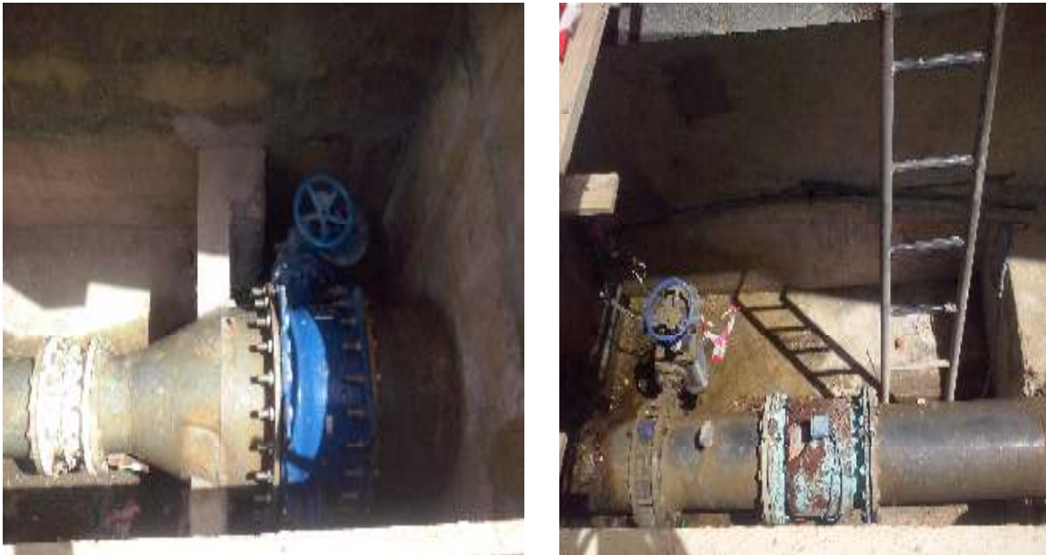
Fig.III.1. Conduite barrage station de l'eau brute (800→400 mm).
