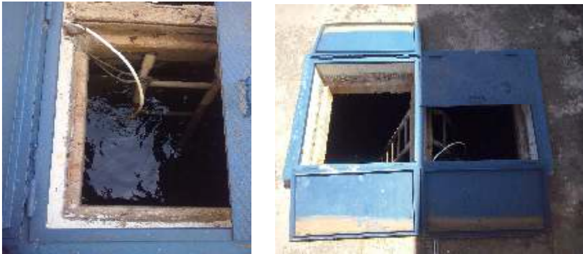
Fig.III.8. Réservoir de désinfection.
