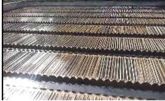
Fig.III.6. Bassin de décantation.
