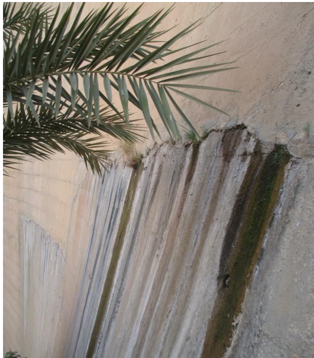
Fig. 3.5. Une fuite d'eau bien visible bien que le lac est au niveau le plus bas (Mai.2017)
