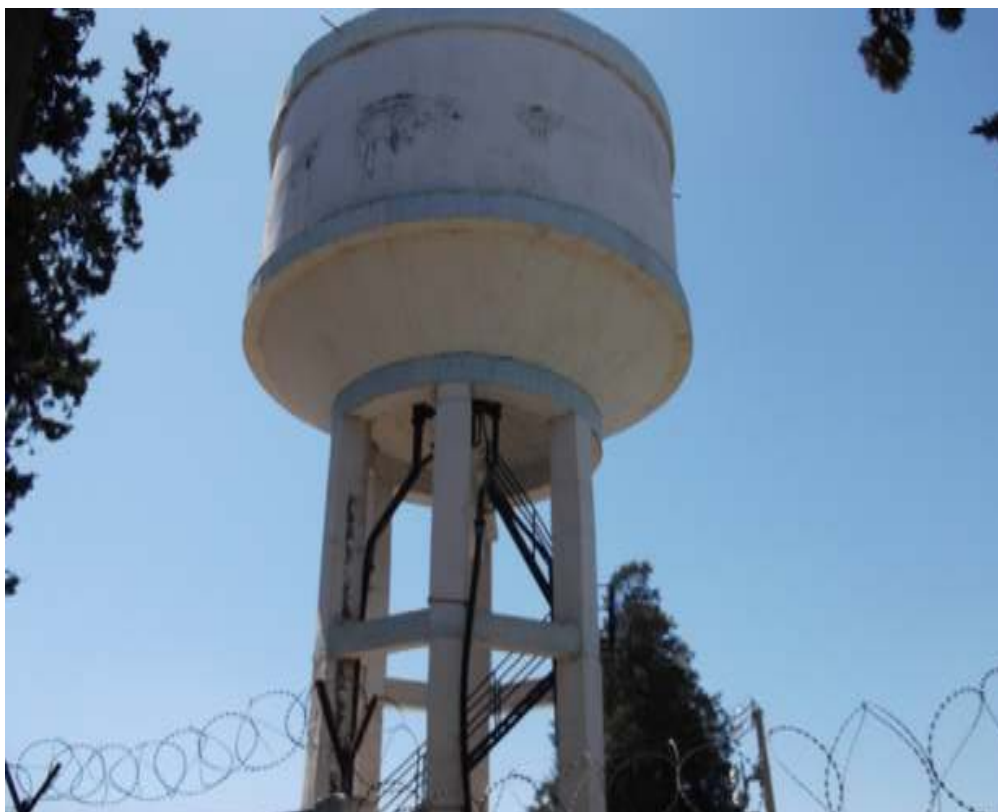
Figure III.4 : Réservoir cinq martyrs
