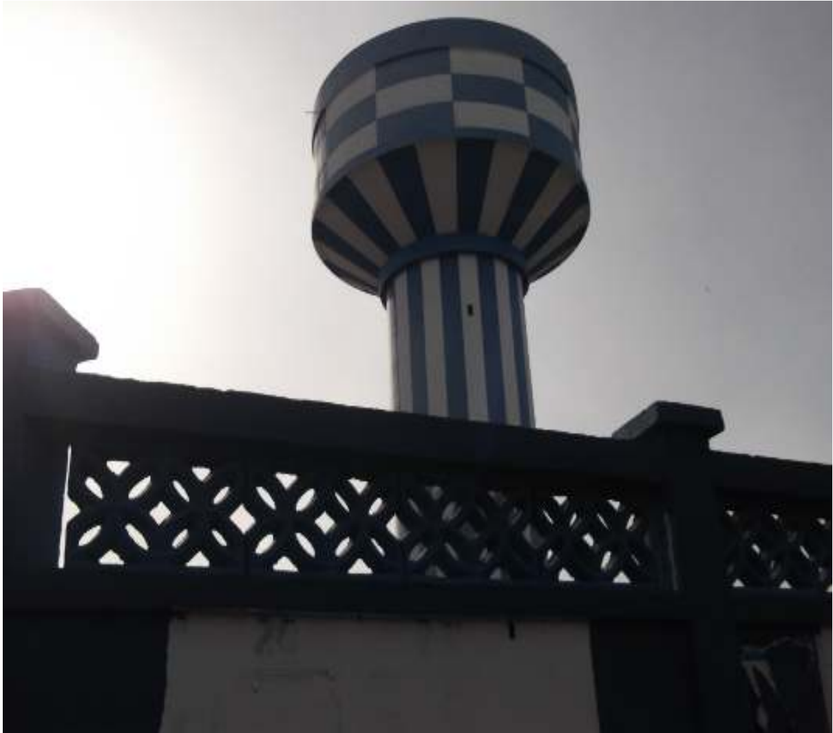
Figure III.3 : Réservoir Houari Abdelkader
