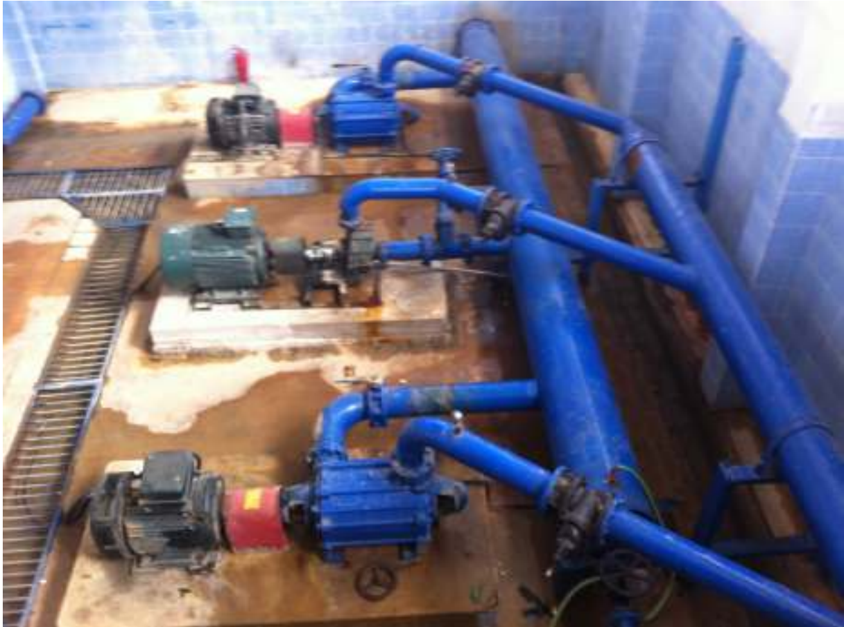
Figure VI.1 photo de la station de pompage existante
