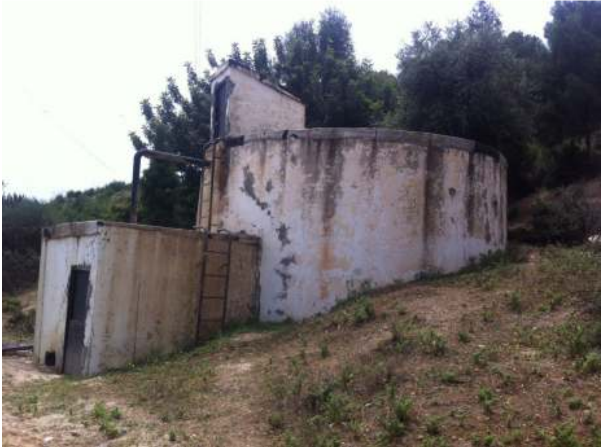
Figure III.5 : Réservoir de 100 m 3 Lahcen Ben Aicha
