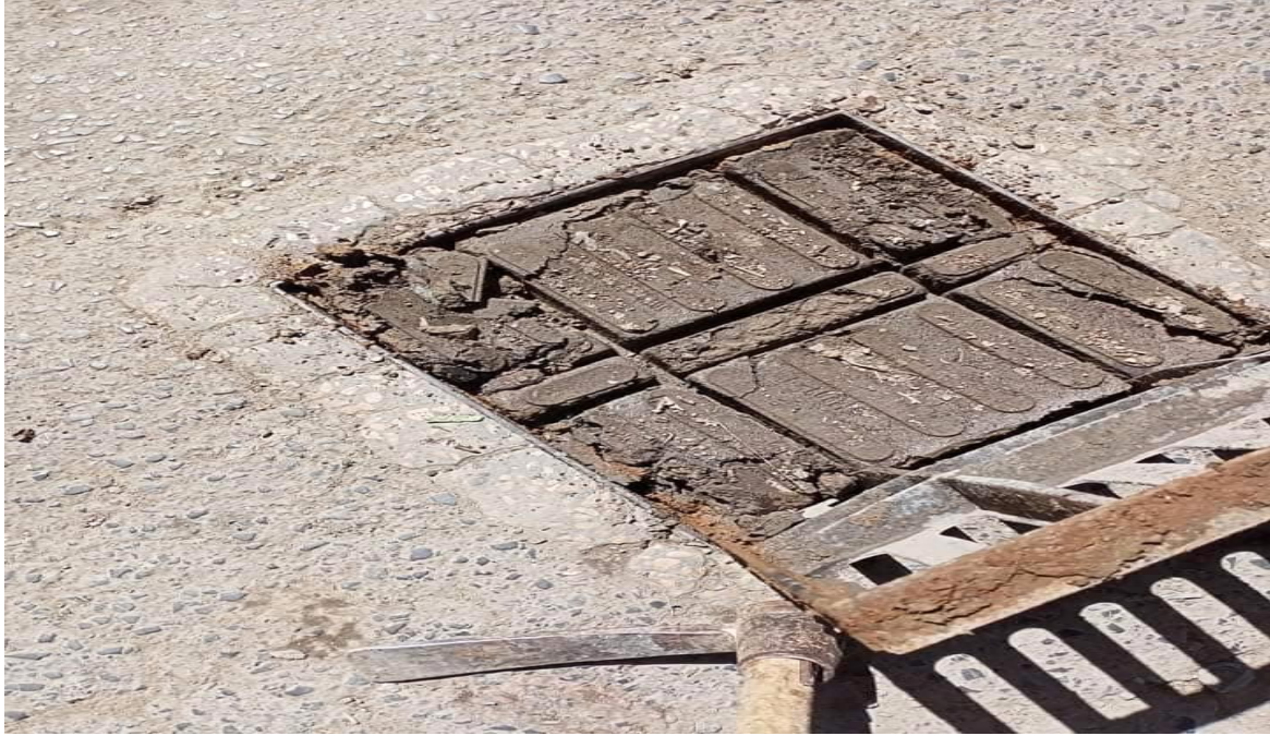
Figure (V-3) : Avaloire totalement bouchée (la rue si benyoucef)
