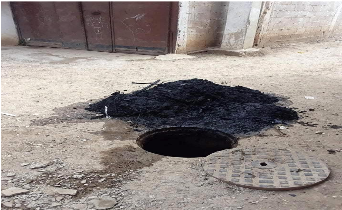
Figure (V-4) : Regard colmaté (rue mohamed bettache)
