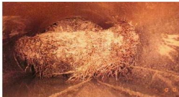
Figure I.8 : Exemple de blocage provoqué par la présence de racines. (REKIOUA M, KHELLAF Z; 2020)
