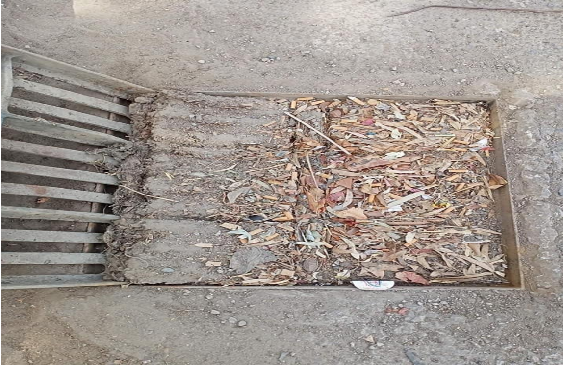
Figure (V-1) : Avoir bouchée (cité benrayan)
