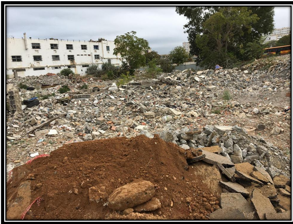
Figure 12 : Libération d'une assiette foncière, la démolition des abattoirs d'Alger source : photo prise par l'autrice
