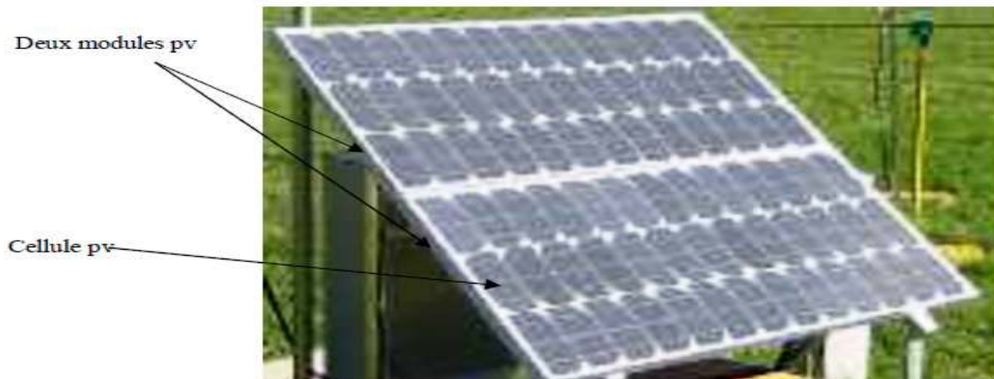
Figure I.17 : Exemple d'un panneau solaire [05].
