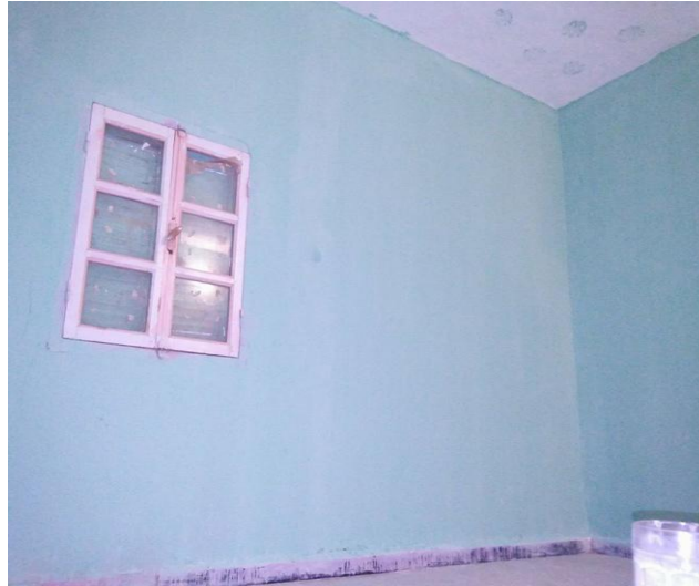
Figure 1.8 : Thermographies d'un coin dans une chambre [6].
