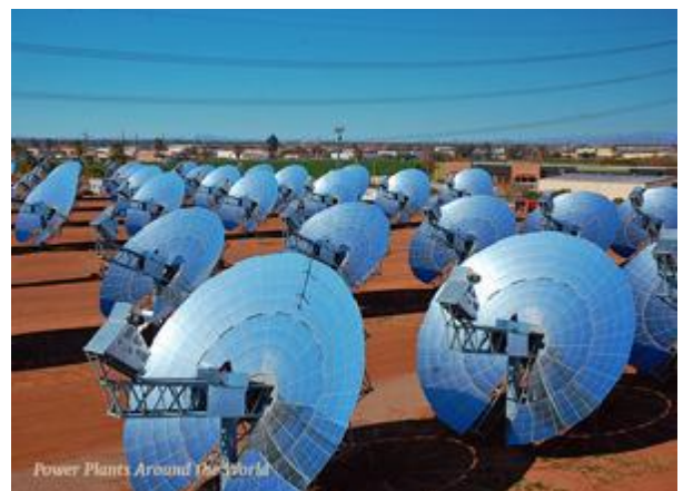
Figure 2.2 : Centrale Solaire de Maricopa (1.5 MW) Peoria/Arizona (2010)
