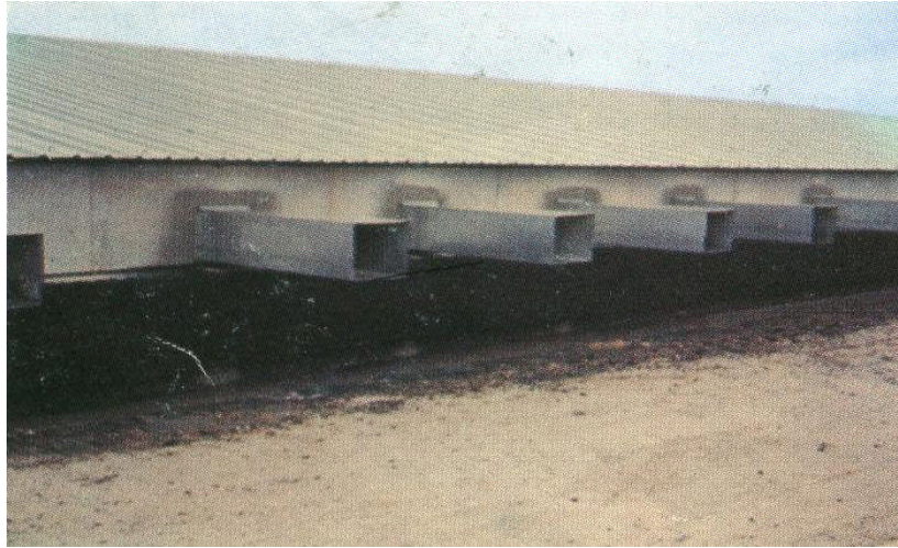
Figure n°3: Orifice à ventilation dans un poulailler à ventilation mécanique. (DEBIEB et HADJ ARAB , 2016)
