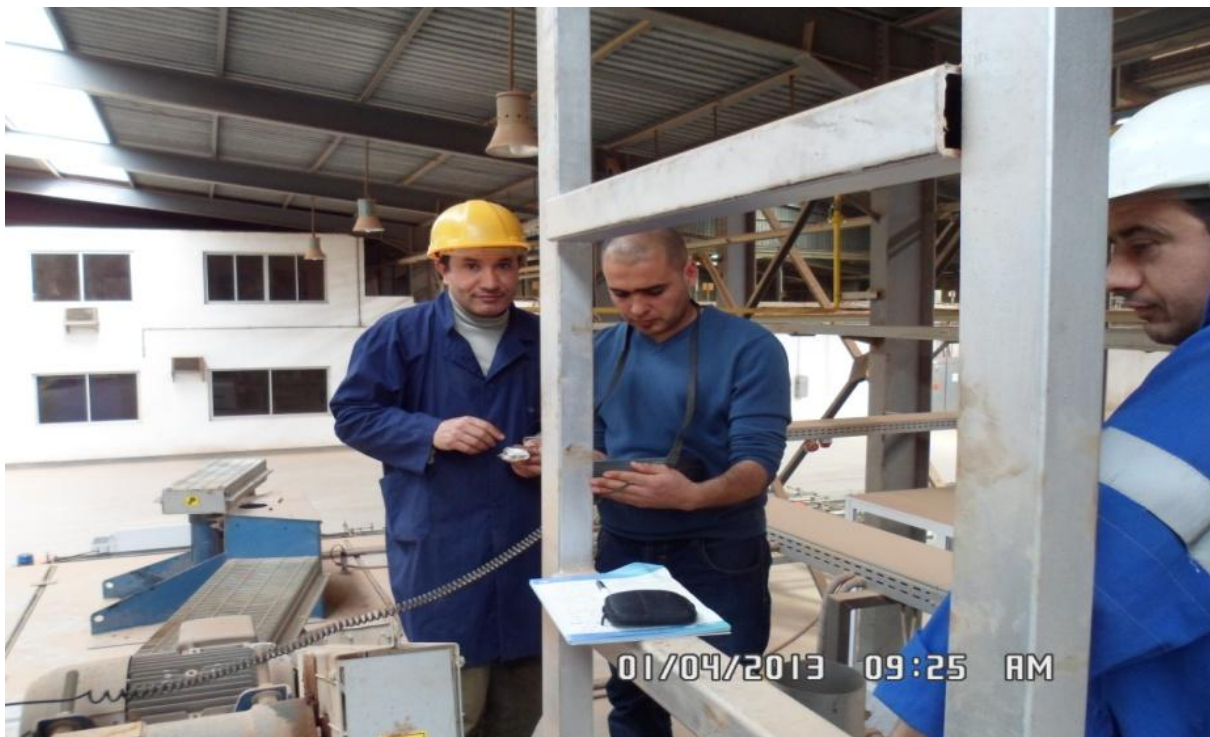
Photo 4-3 prise de mesures des vibrations du ventilateur
