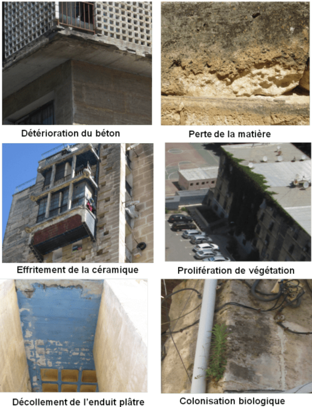
Figure 3. 13: Les différentes formes de dégradation et les pathologies apparentes identifiées.
