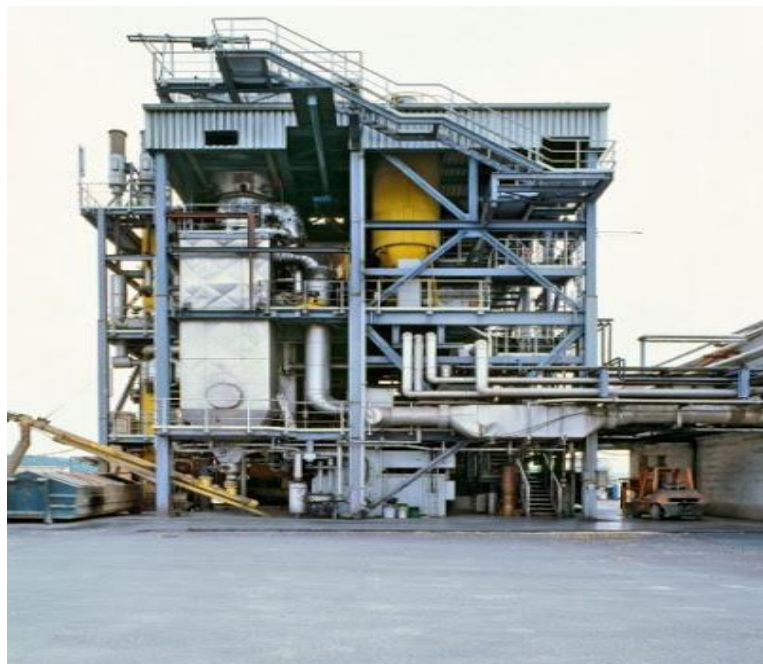
Figure 1.20 Centrale de Cogénération de Gussing
