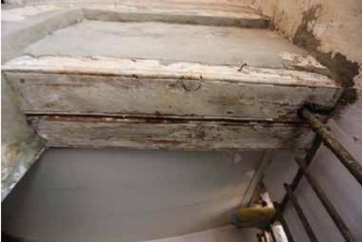
Fig.21 : Utilisation du Bois en tant que linteau d'une porte (Modi cation poste coloniale).
