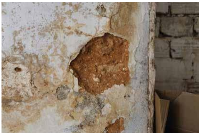
Fig.10 : Liant sur un mur sur l'entree de la maison (Patio).
