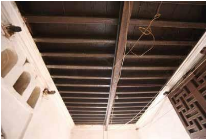
Fig.24 : Toiture en Bois au niveau de l'entree du Haouch (Patio) suite au r'ajout de l'acier durant la periode coloniale.
