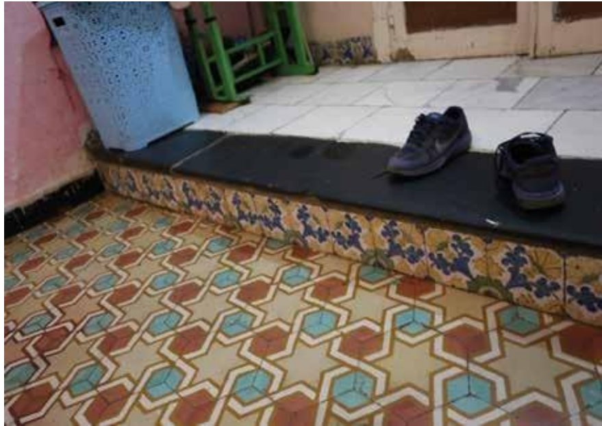
Fig.26 : Careaux de ceramique avec une composition pleurale sur le hall distributeur du 1er Etage.
