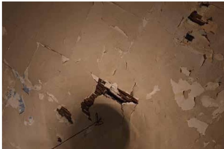
Fig.49 : Vue sur un Plafond au niveau d'une des chambres au 1er etage.
