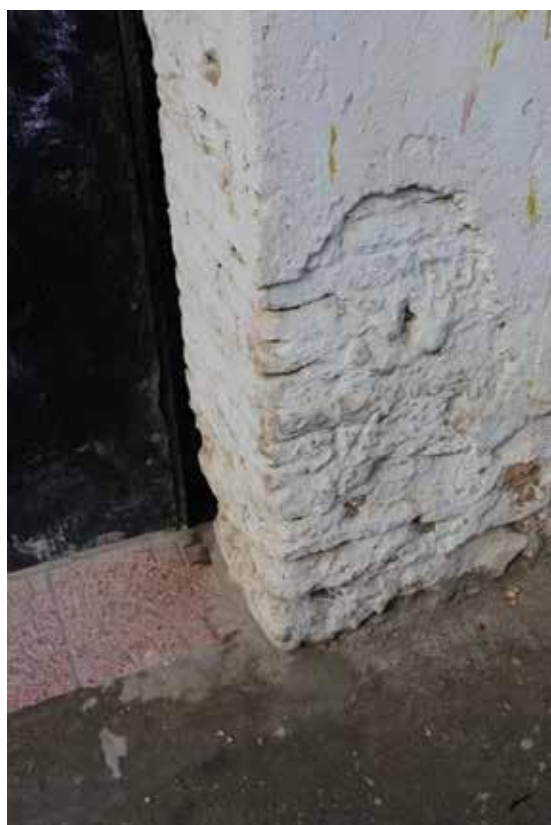
Fig.12 : Liant sur mur d'entree en brique pleine.
