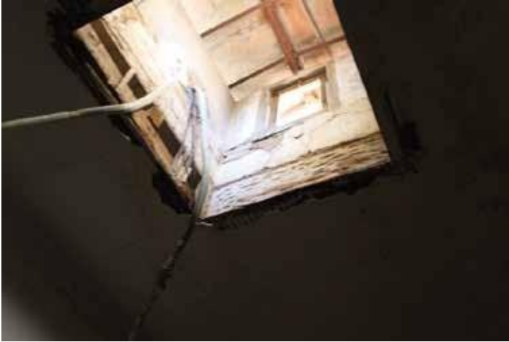
Fig.55 : Croquis sur le puits de Lumiere centrale au niveau du Plafond du 1er etage.
