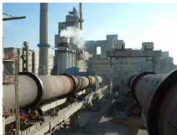
Figure I.2. Four rotatif à ciment en voie humide
