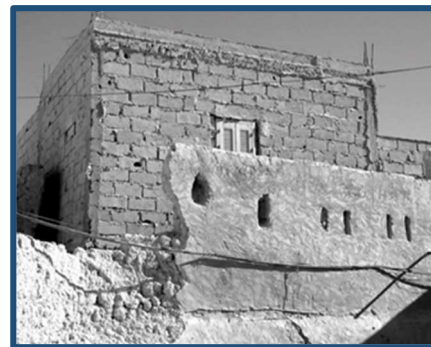
FIGURE I.3 : Maison au ksar, avec les technique de construction non-adapté à la région.
