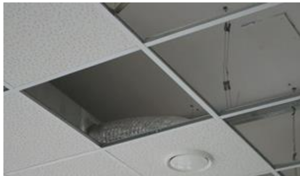
FigureIII-76 : Faux plafond en plaques de plâtre Source : https://www.filipeisolation.fr/
