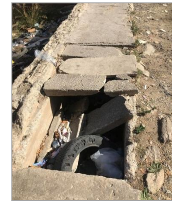
Fig 53 :Canaux d'égoutde la cite climat de France
