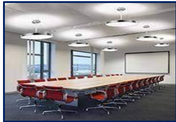
Fig.III-83 : l'éclairage biodynamique Source : image Google
