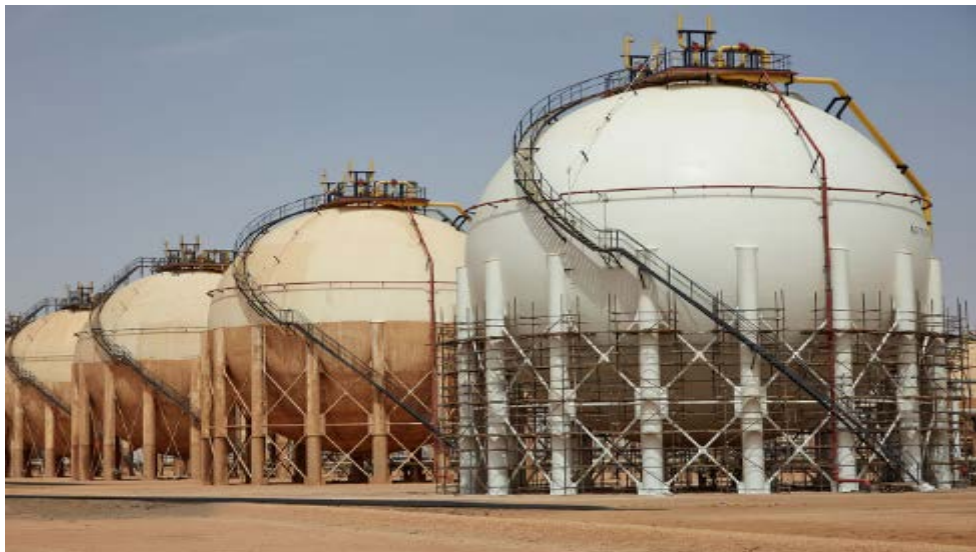
Figure I.5 Sphère de stockage.
