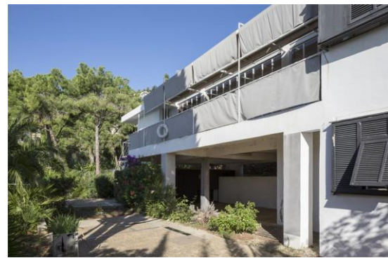
Persiennes pour ventiler et protéger du soleil. Source : wikiarquitectura.com
